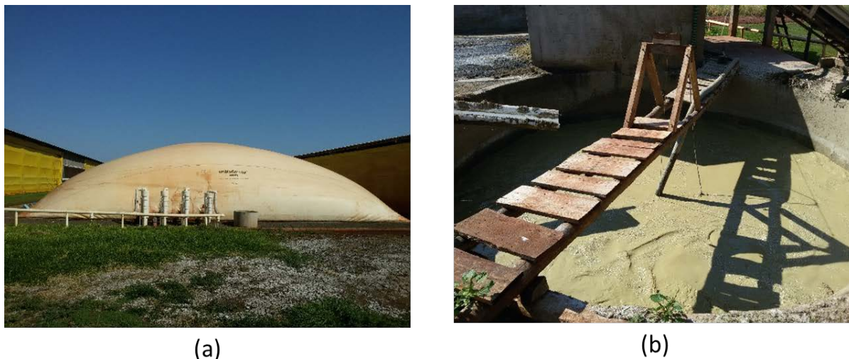
Figura 2 - (a) Biodigestor em operação; (b) Misturador alimentação do biodigestor.
