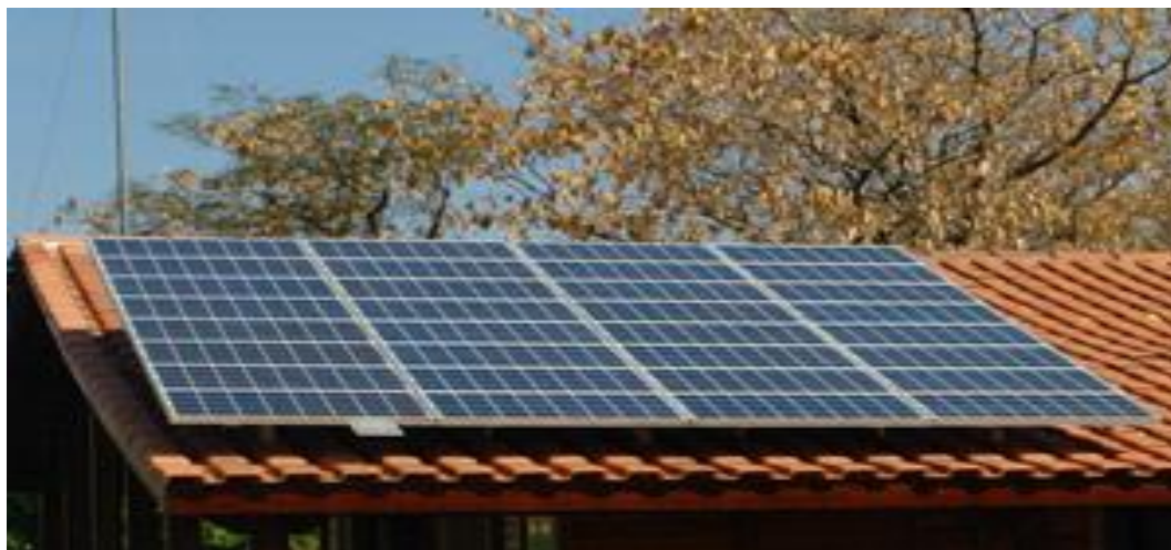
Figura 18: Painéis fotovoltaicos instalados no telhado de um quiosque.
