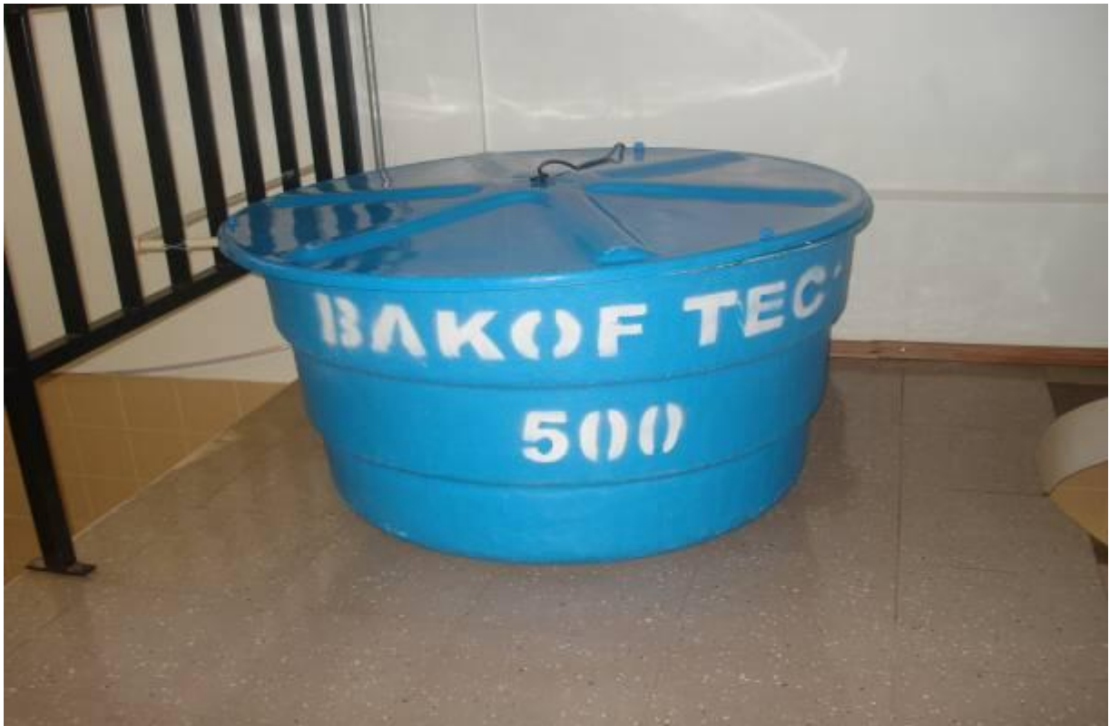
Figura 3 – Reservatório de resfriamento
