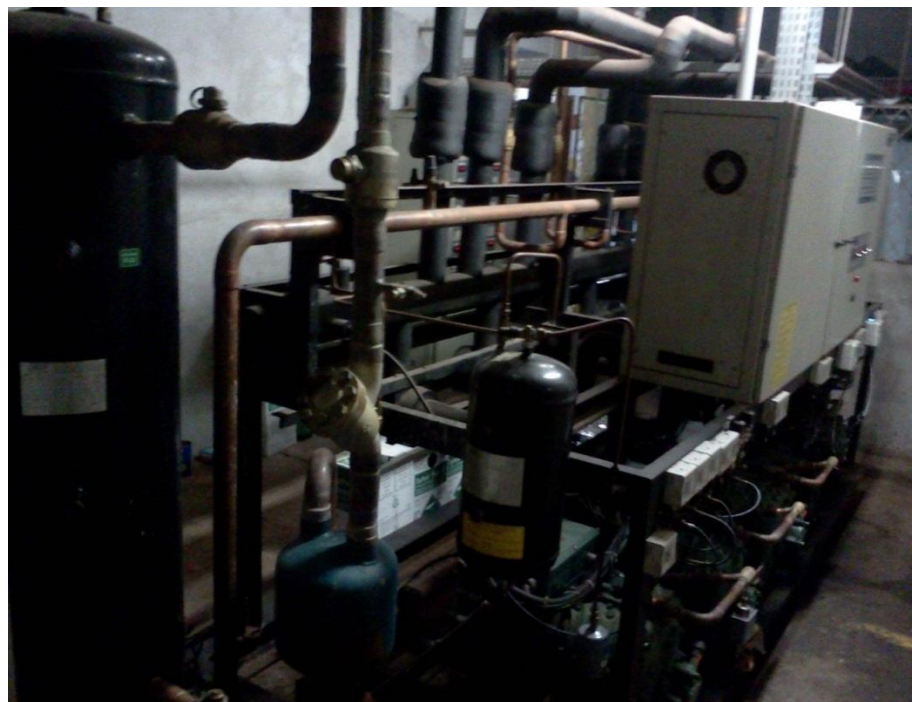
Figura 6 – Exemplo da Casa de Máquinas de Refrigeração. Fonte: Silva Diogo e Antunes Marcos
