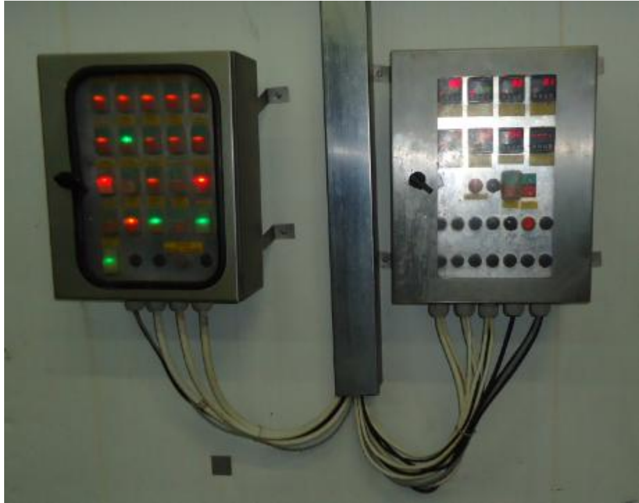
Figura 19: Painel de operação Chiller antes da implantação; Fonte: Autor.
