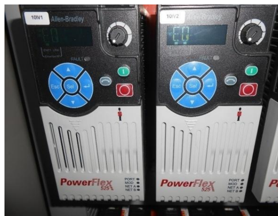
Figura 27: Inversor de frequência Allen-Bradley;
