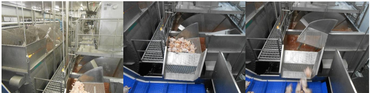
Figura 16:Chiller de resfriamento; Fonte: Autor.
