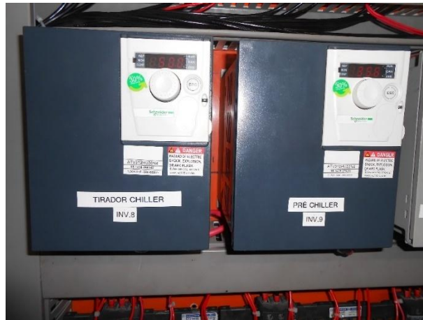
Figura 28: Inversor de frequência Schneider Atv312; Fonte: Autor.
