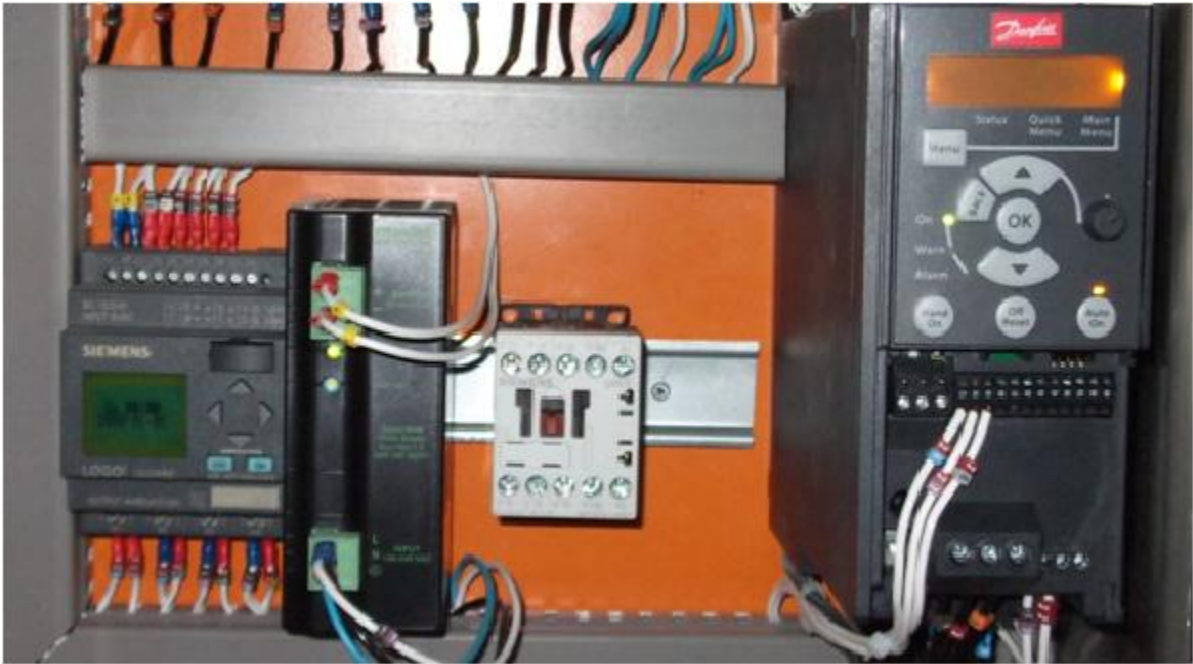
Figura 18 - CLP, Fonte 24 Vcc e Inversor de Frequência
