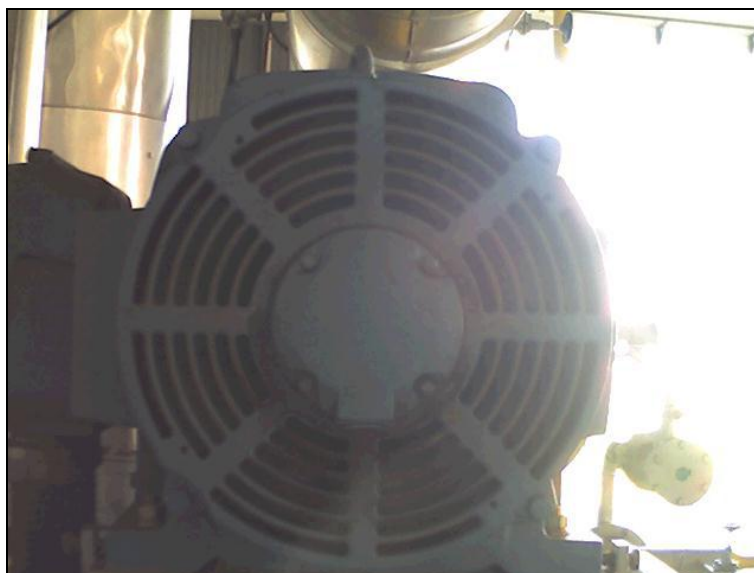
Figura 9 - Motor do compressor de amônia.
