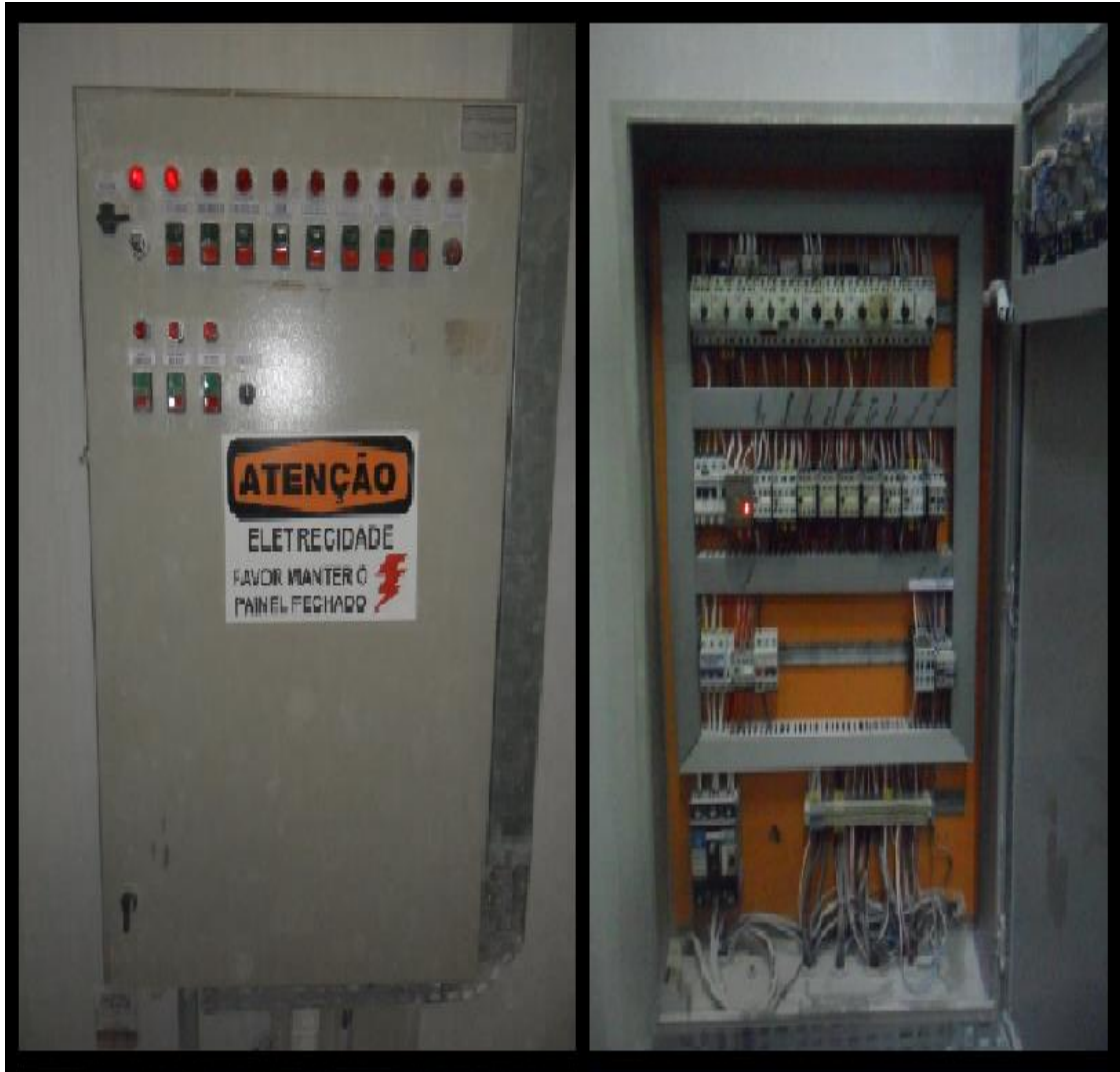
Figura 4 - Painelelctrico existente na linha de ensaque de amido de milho
