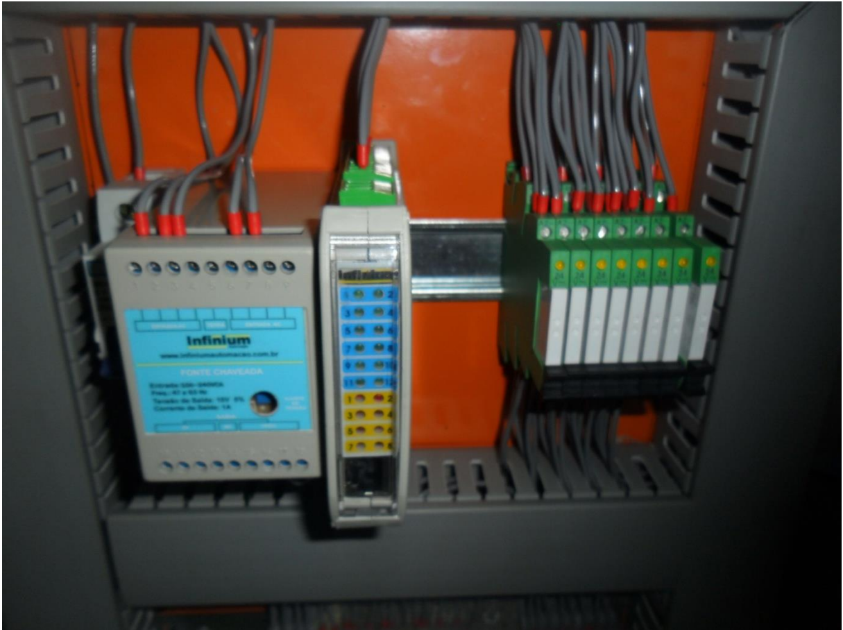
Figura 7 - Painel elétrico montado para automação.
