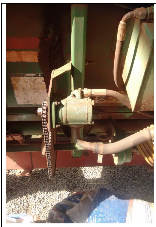
Figura 13: Bomba fixada ao suporte em aço. Fonte: Os autores.
