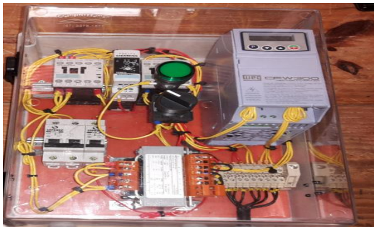
Figura 8 - Quadro de comando.
