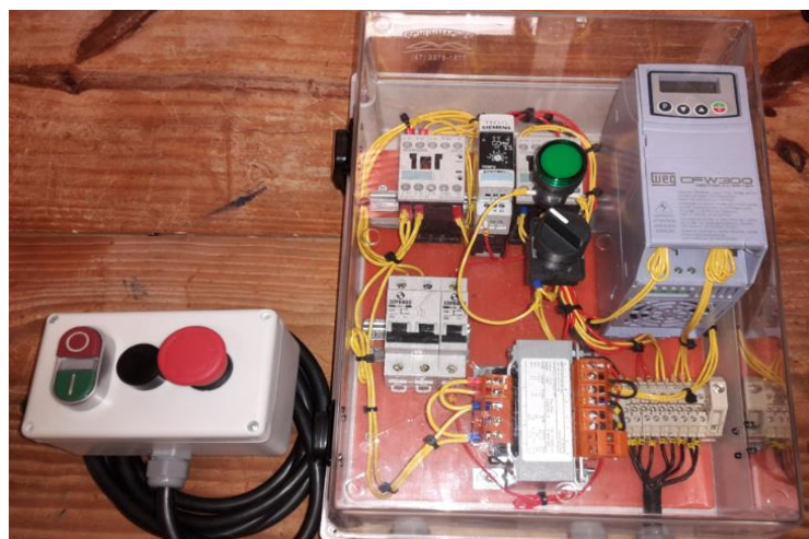
Figura 40 - Quadro de comando e caixa de acionamento.
