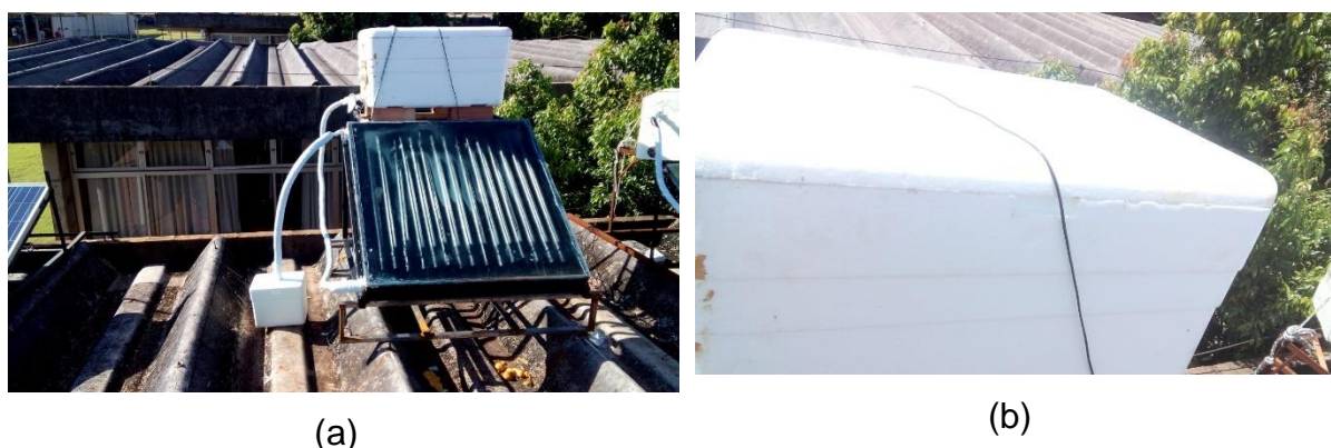
Figura 45: (a) Abertura da Tubulação para o escoamento da água quente para outro reservatório. (b) Sensor de temperatura inserido no interior do reservatório principal.
