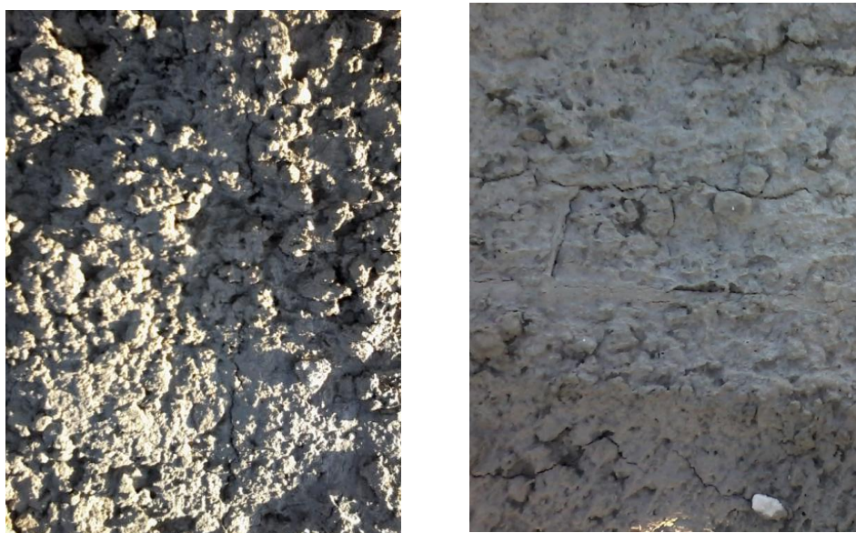
Figura 24- Fissuras causadas pela retração plástica na Concretagem 3 Fonte: As autoras (2016).
