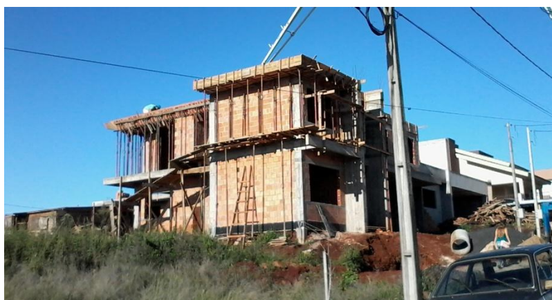
Figura 22- Ausência de proteção solar na obra da Concretagem 2 Fonte: As autoras (2016).
