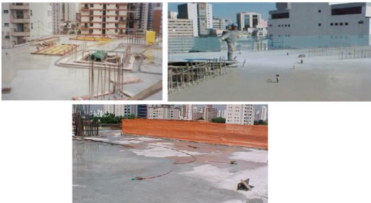
Figura 5 - a) Cura com água por molhagem direta b) Cura com lâmina de água c) Cura por aspersão
