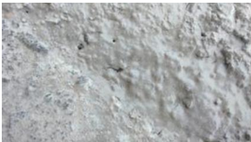
Figura 19- Fissuras causadas pela retração plástica na Concretagem 1 Fonte: As autoras (2016).
