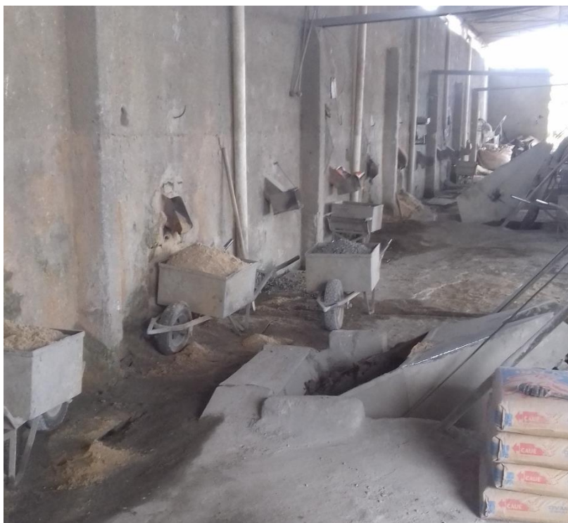
Figura 16 - Bocais de retirada dos agregados Fonte: Aatoria Própria (2018).
