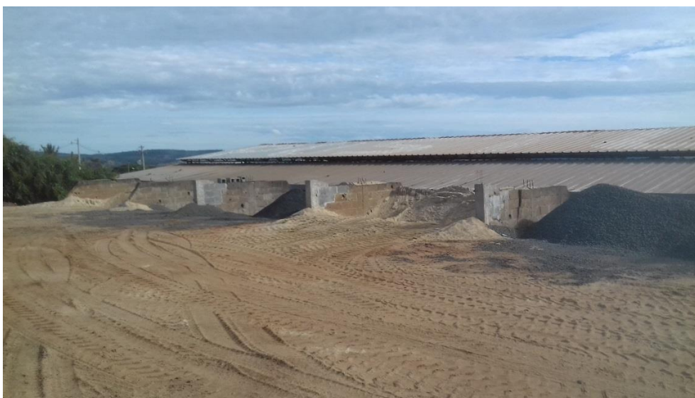
Figura 13 - Baias de armazenamento dos agregados Fonte: Aatoria Própria (2018).
