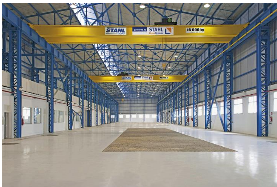
Figura 36 - Pontes Rolantes Fonte: Stahl (2018).
