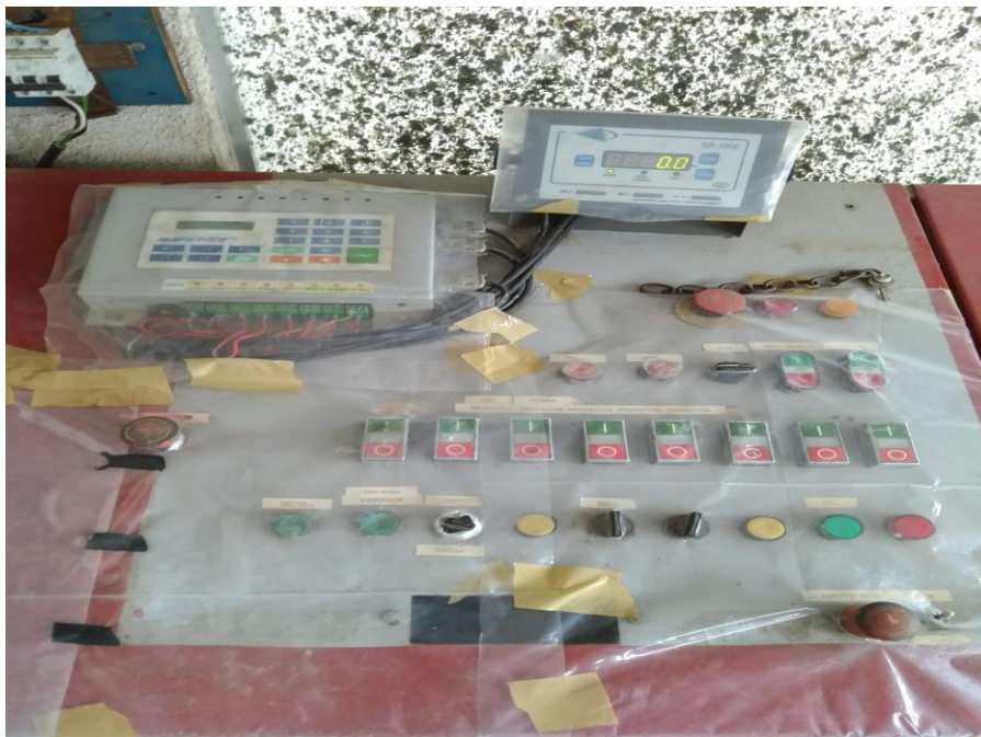
Figura 6: Painel de controle da Usina Dosadora Fonte: Autoria Própria (2018).
