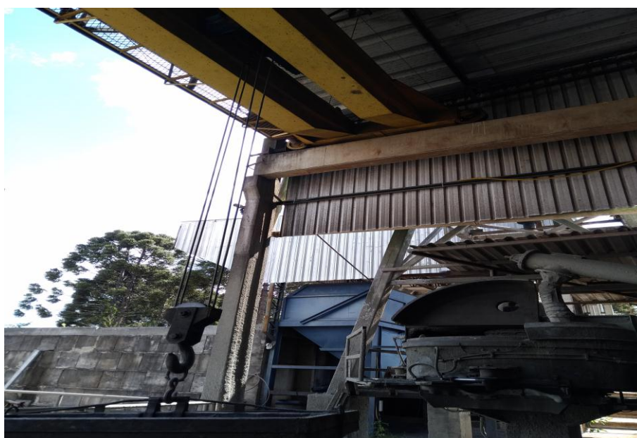
Figura 12: Ponte rolante para içamento do reservatório de concreto até a forma desejada Fonte: Autoria Própria (2018).
