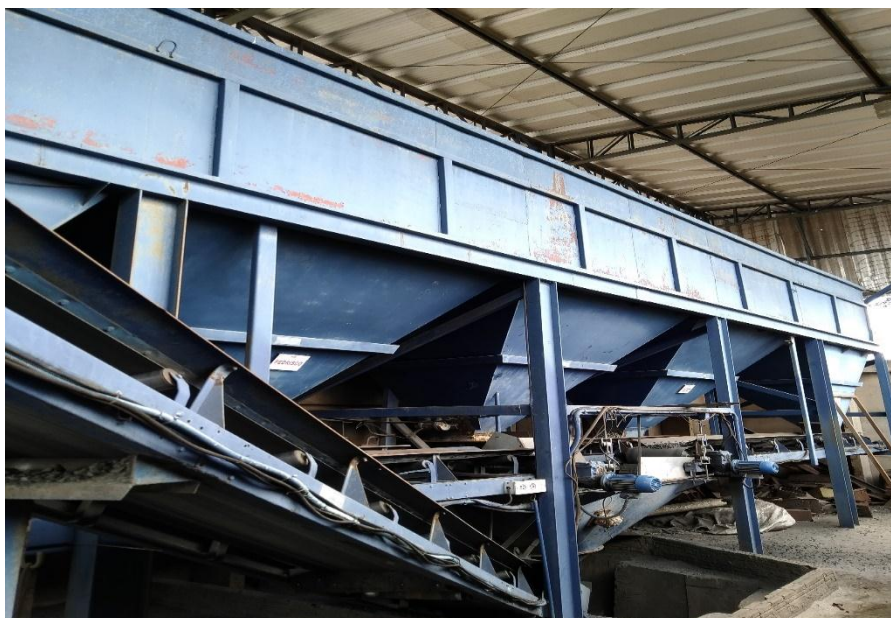
Figura 5: Estocagem, balança e esteiras da Usina Dosadora Fonte: Autoria Própria (2018).
