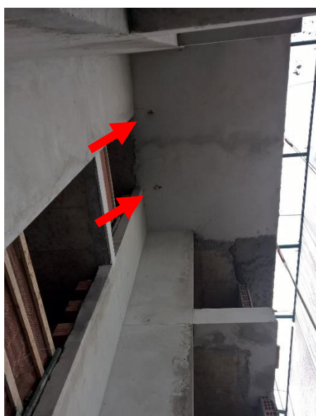
Figura – Furos feitos posteriormente para passagem de cabos de aço
