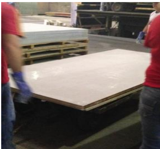
Figura 20 - Chapa OSB recebendo placas cimentícias em suas faces. Fonte: Acervo do autor (2014).
