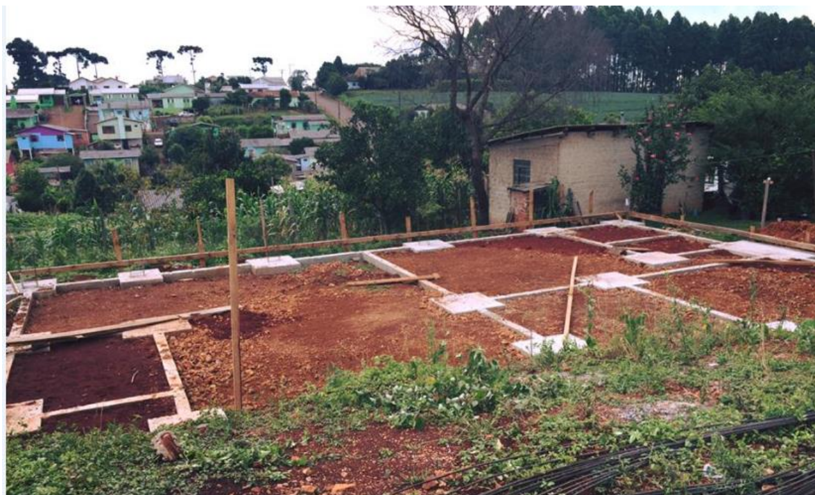
Figura 61 – Fundação do Tipo Sapatas e Baldrame Fonte: Modular, 2015.
