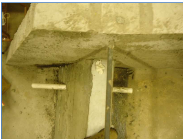
Figura 39 - Detalhe da tubulação para posterior montagem de vertedor tulipa. Fonte: As autoras (2013).
