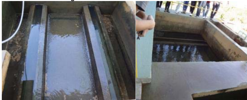
Figura 9: Filtros da ETA de Pato Branco
