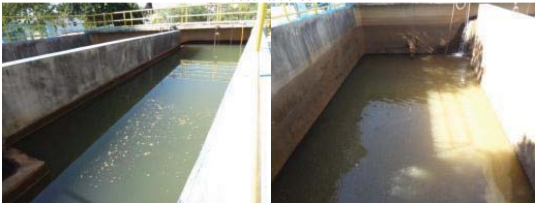
Figura 11:reservatório de acumulação de águas de lavagens de filtros e dos decantadores
