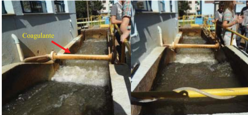
Figura 6: Aplicação do PAC na ETA de Pato Branco
