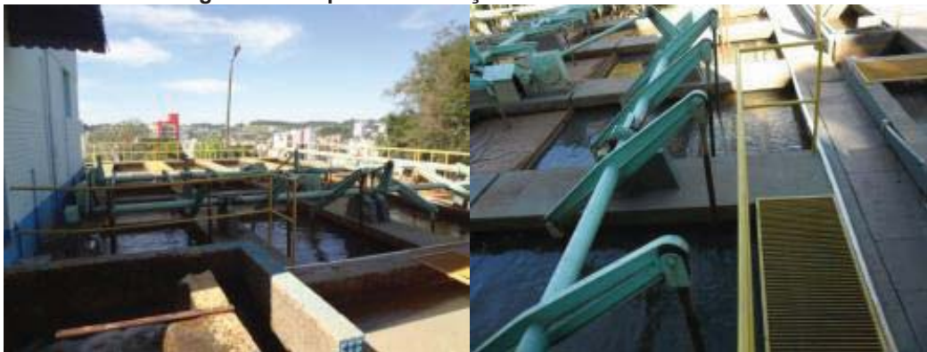
Figura 7: Tanque de floculação da ETA de Pato Branco
