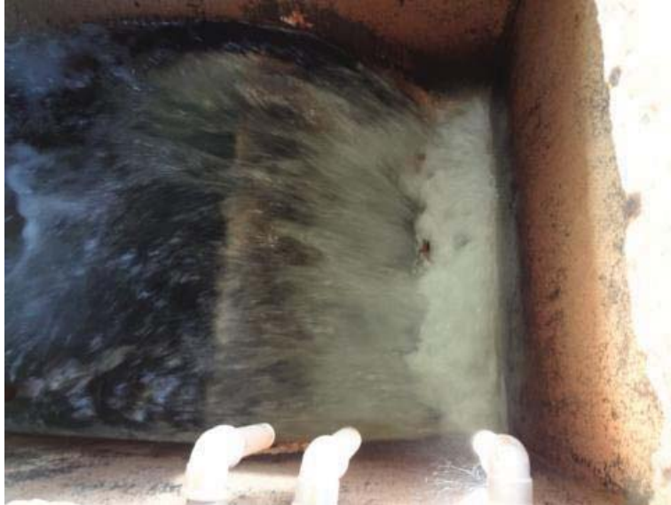
Figura 10: Desinfecção da água na ETA de Pato Branco
