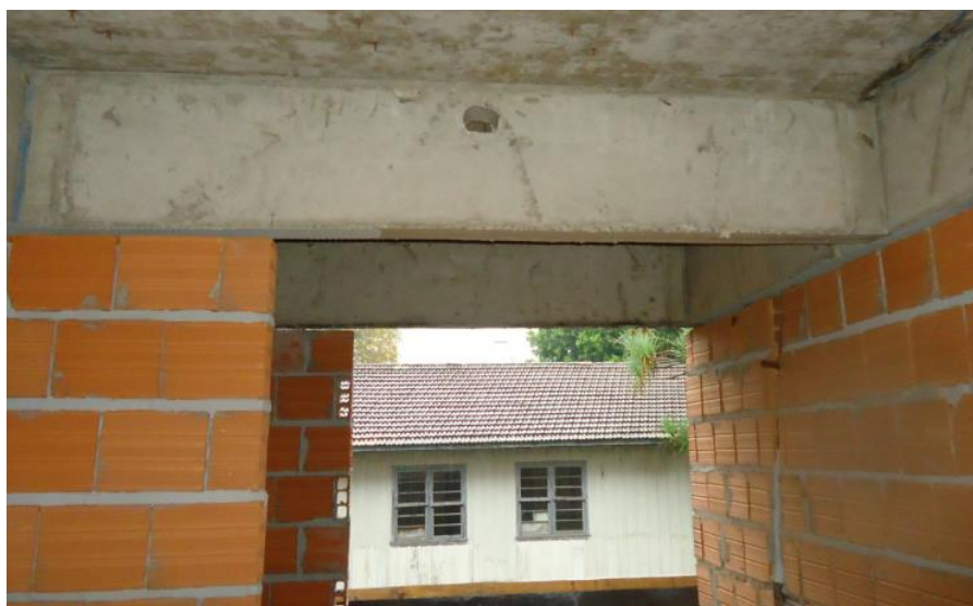
Figura 27 - Passagem de tubulação no sentido da largura da viga - Obra "B" Fonte: Autoras (2015).
