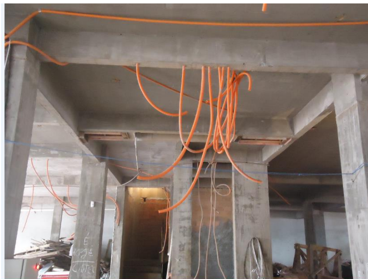
Figura 23 - Passagem de tubulações por meio de vigas no sentido da altura - Obra "A" Fonte: Autoras (2015).
