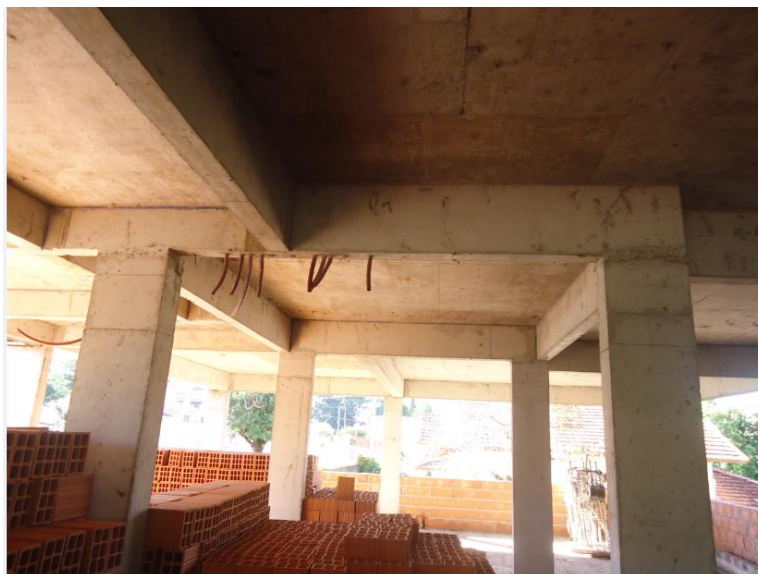
Figura 24 - Passagem de tubulações por meio de vigas no sentido da altura - Obra "B" Fonte: Autoras (2015).
