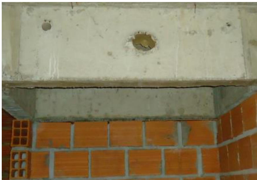
Figura 26 - Passagem de tubulação no sentido da largura da viga- Obra "B" Fonte: Autoras (2015).
