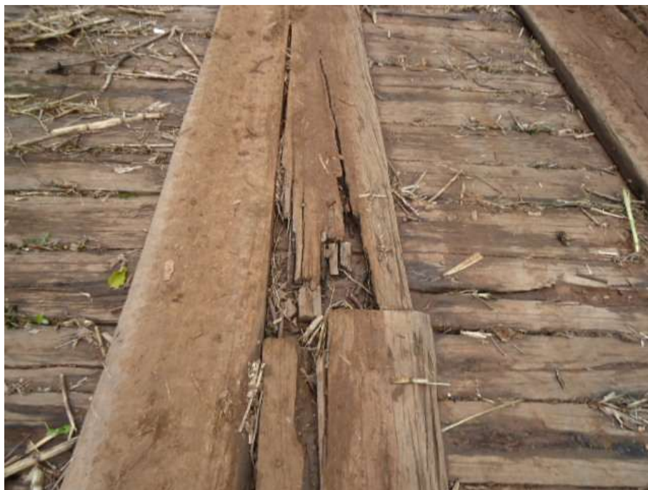
Figura 64 – Peças danificadas pela sobrecarga
