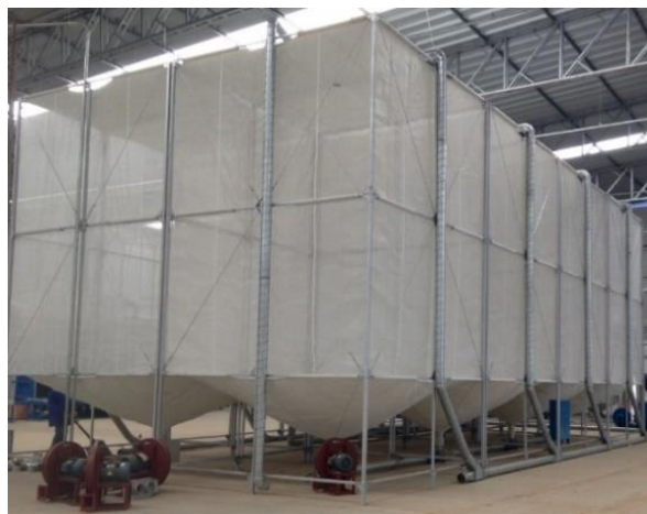
Figura 3: Silos ventilados para estocagem do EPS Fonte: CAPIVARI, 2016.
