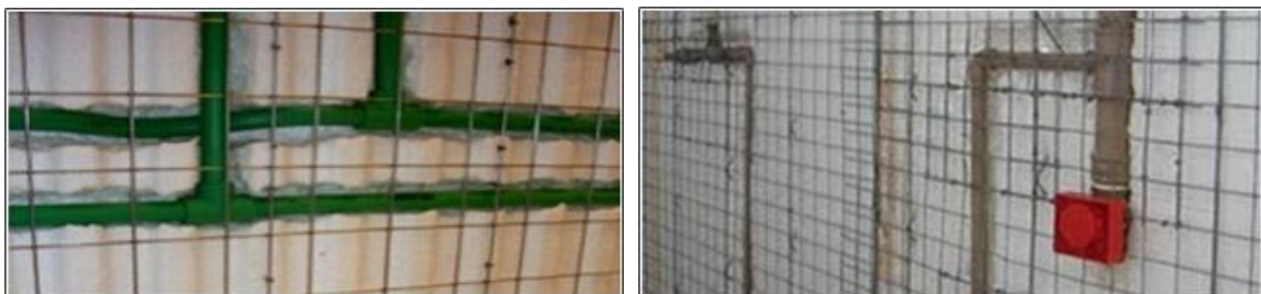
Figura 33: Instalação hidráulica Fonte: MONOFORTE, 2016.
