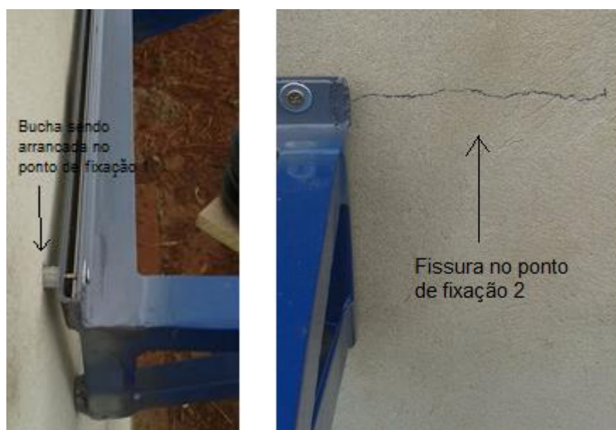
Figura 75: Desprendimento da bucha do ponto 1 e fissuração do ponto 2 Fonte: O AUTOR, 2017.
