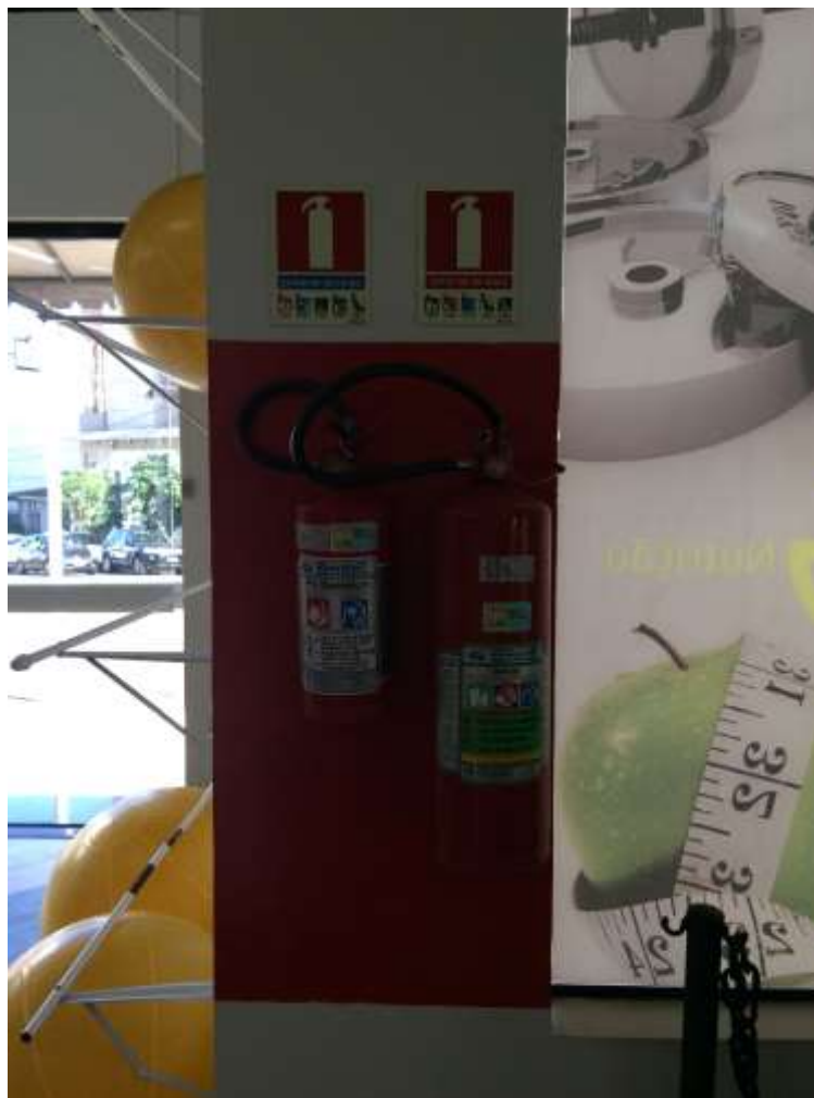
Foto 3: Extintores na academia. Fonte: Vasata, A. C. D. P. (2017).
