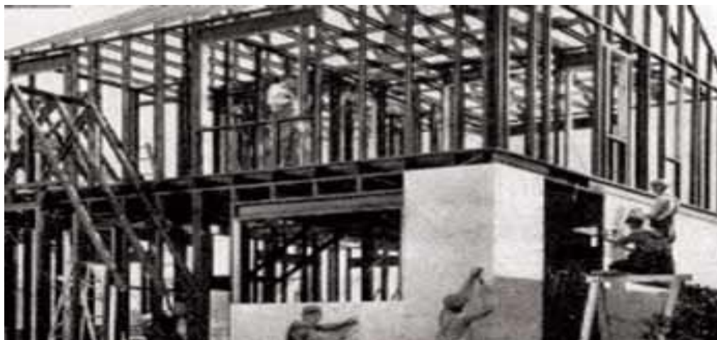
Figura 3: Protótipo de residência em Steel Frame na Exposição Mundial de Chicago em 1993 (Fonte: CRASTO, 2006).
