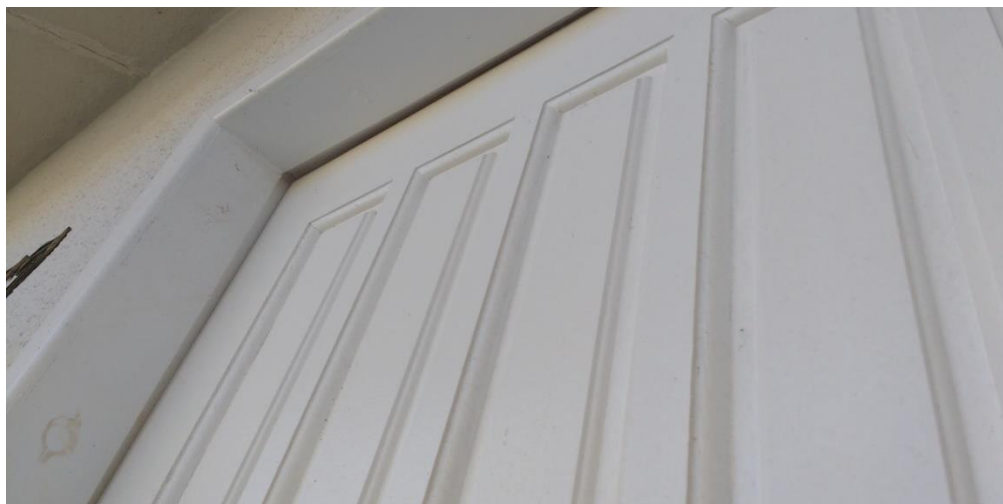
Figura 30: Flancos da Porta de Entrada da Casa 1 em LSF. (Fonte: PERIN; MASSAROTTO, 2017)
