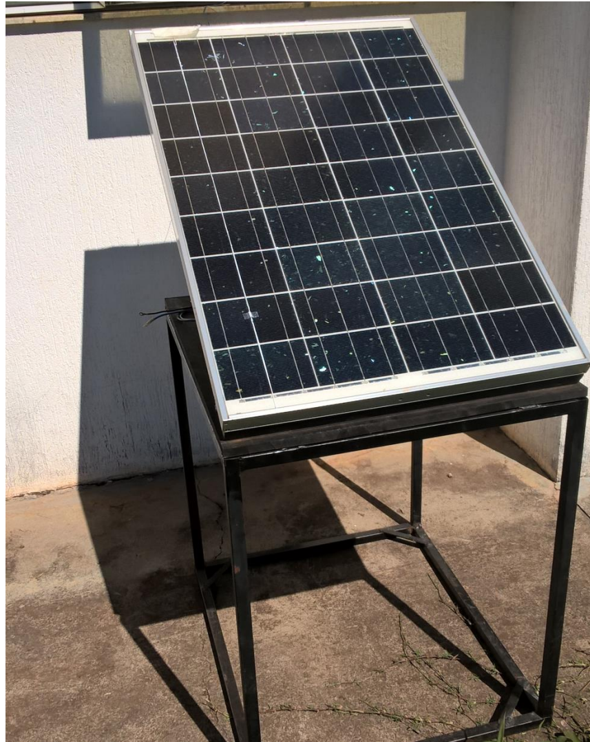
Figura 19 - Painel fotovoltaico instalado Fonte: Autoria própria.
