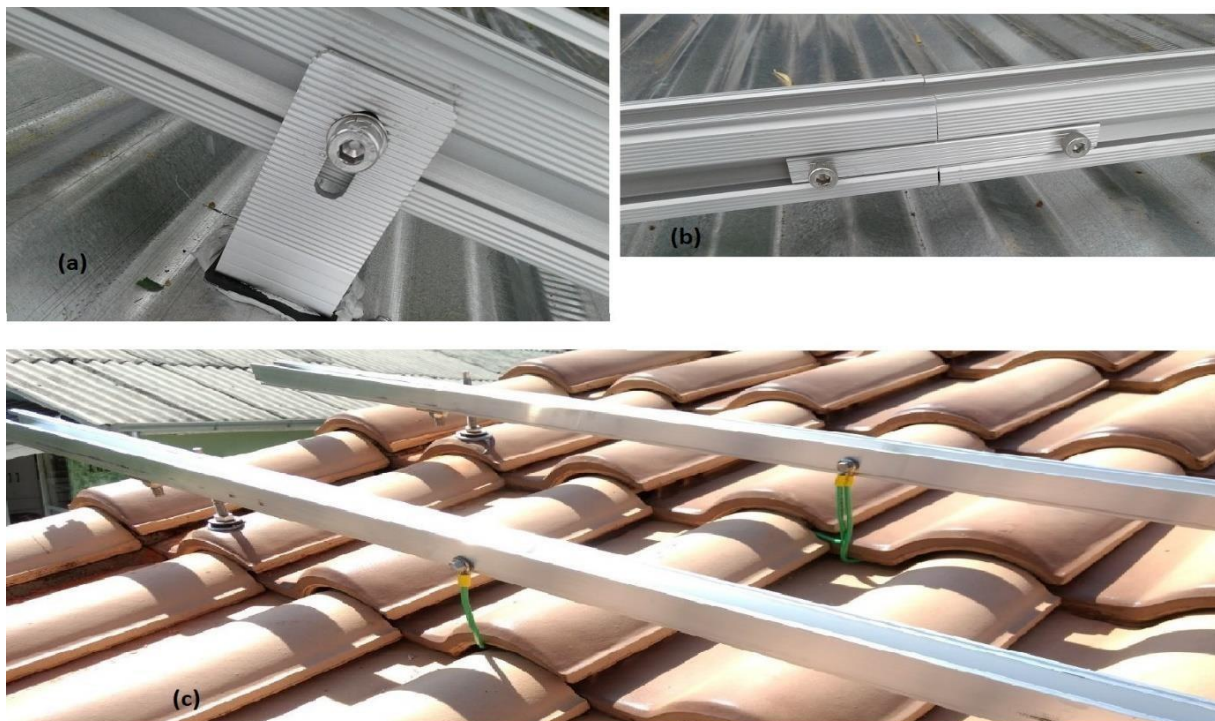
Figura 19. a) utilização do grampo intermediário, b) utilização da junção dos perfis, c) perfis de alumínio e aterramento. Fonte: Autoria própria.
