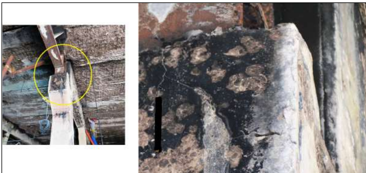
Figura 17 - Ruptura do consolo do pilar, paletização 1º nível. Fonte: Laudo técnico - Empresa B.
