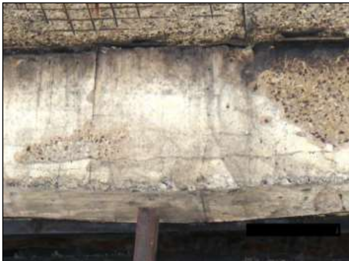
Figura 30 - Fissura em viga por flexão, paletização 1º nível. Fonte: Laudo técnico - Empresa B.
