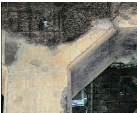
Figura 25 - Coloração do concreto, cinza esbranquiçada, na paletização do 1º nível.
