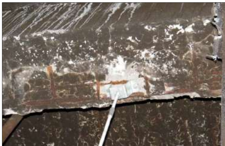
Figura 29 – Viga com corrosão nas armaduras, paletização do 2º nível.
