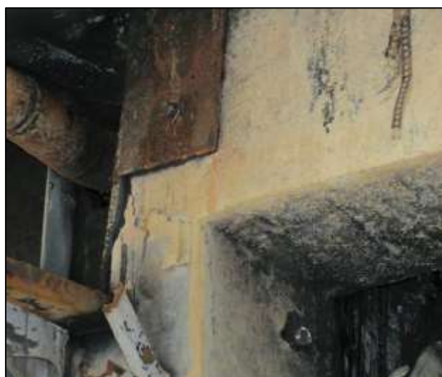
Figura 31 - Fissura no engaste viga - pilar, paletização 1º nível. Fonte: Laudo técnico - Empresa B.
