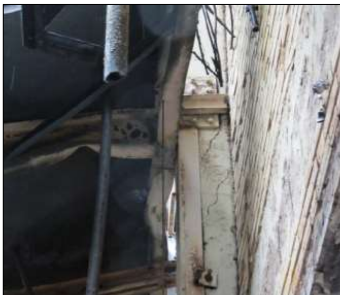
Figura 19 - Pilar com ruptura no engaste da estrutura metálica, paletização 2º nível.
