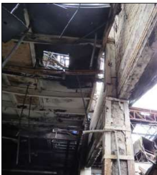
Figura 18 - Pilar com ruptura no engaste com estrutura metálica, paletização 2º nível. Fonte: Laudo técnico - Empresa B.
