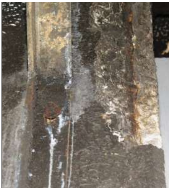
Figura 28 – Pilar com corrosão nas armaduras, paletização do 2º nível.
