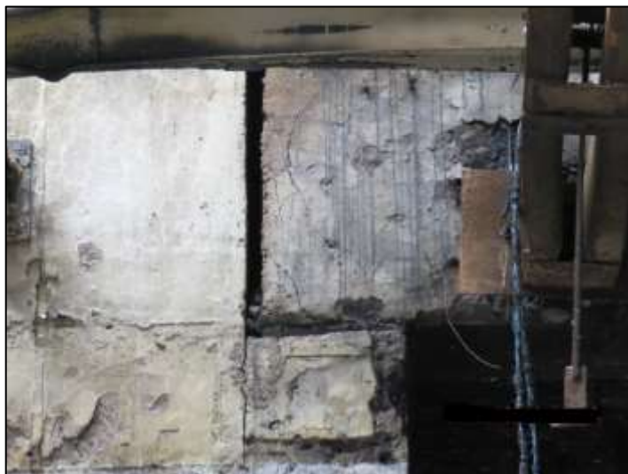
Figura 22 - Viga com ruptura por flexão e torção, paletização 2º nível. Fonte: Laudo técnico - Empresa B.
