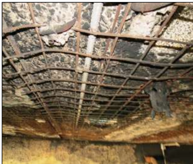
Figura 10 - Lascamento do concreto da laje, paletização 1º nível. Fonte: Laudo técnico - Empresa B.
