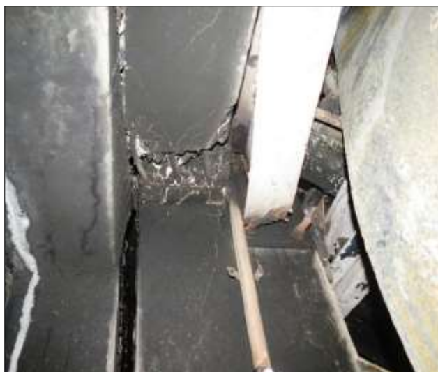
Figura 20 - Ruptura de viga, paletização 2º nível. Fonte: Laudo técnico - Empresa B.
