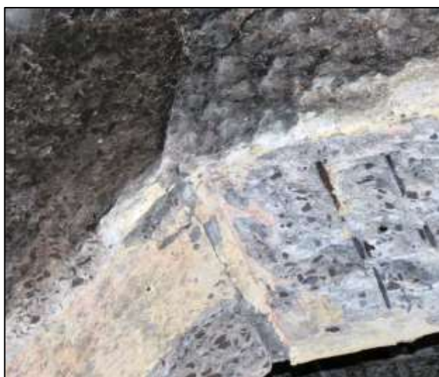
Figura 13 - Delaminação gradual do concreto em uma viga, paletização 1º nível. Fonte: Laudo técnico - Empresa B.
