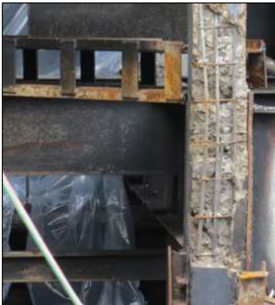
Figura 15 - Ruptura de pilar, caixaria 3º nível. Fonte: Laudo técnico - Empresa B.
