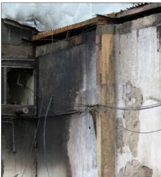
Figura 24 - Coloração do concreto, amarelo alaranjado na caixaria do 3º nível.
