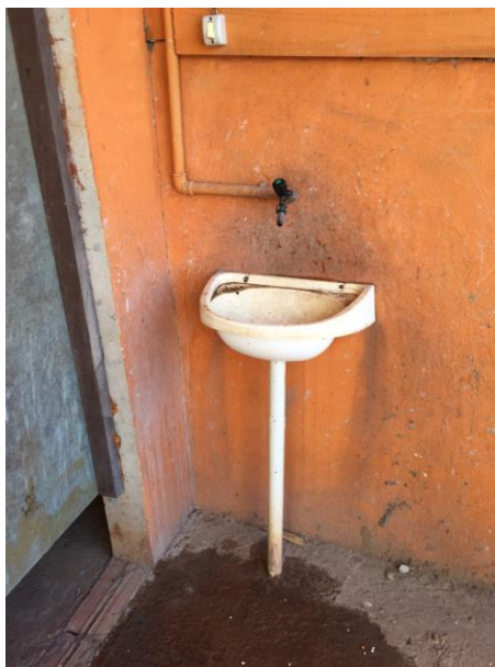
Figura 5. Lavatório, obra C. Fonte: Autora, 2015.
