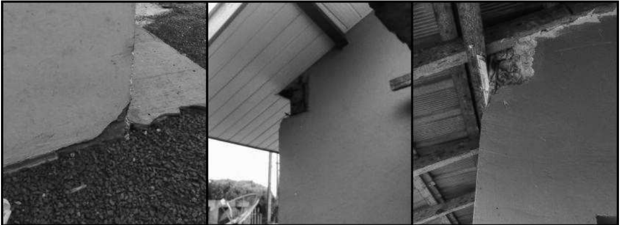
Figura 36: Patologia de descolamento do reboco em placas
