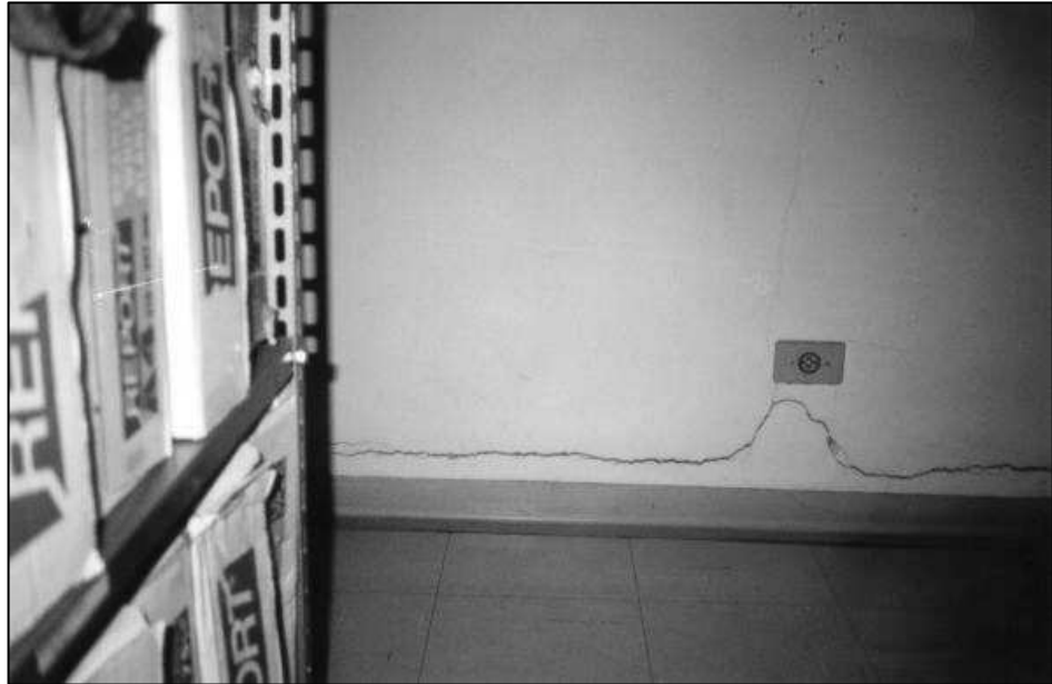
Figura 6: Trinca horizontal em parede
