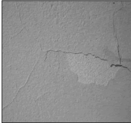
Figura 14: Descolamento da pintura na parede
