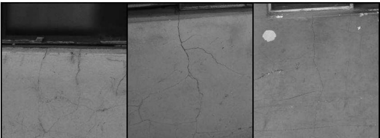
Figura 29: Trincas e fissuras verticais
