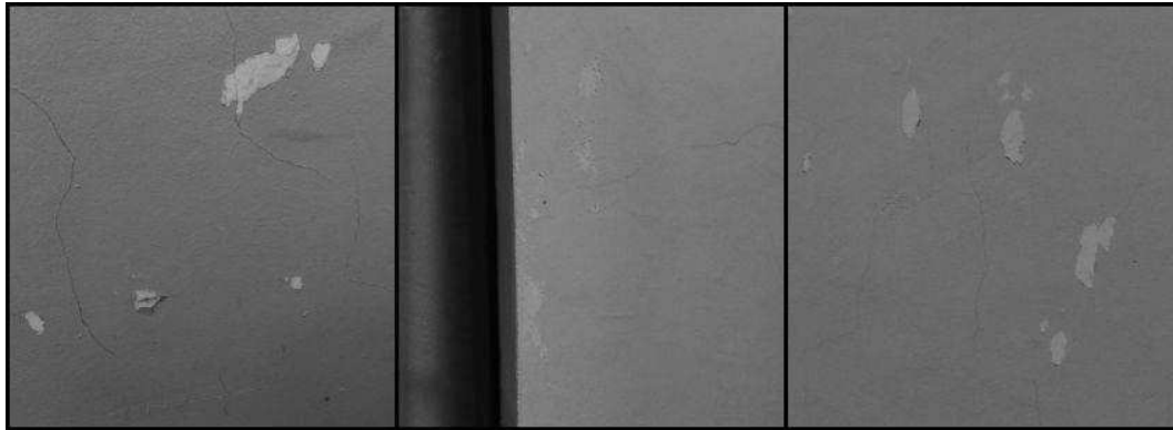
Figura 34: Descolamentos de pintura
