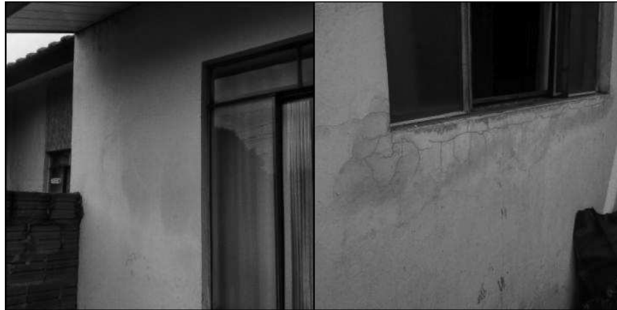
Figura 31: Manchas de umidade
