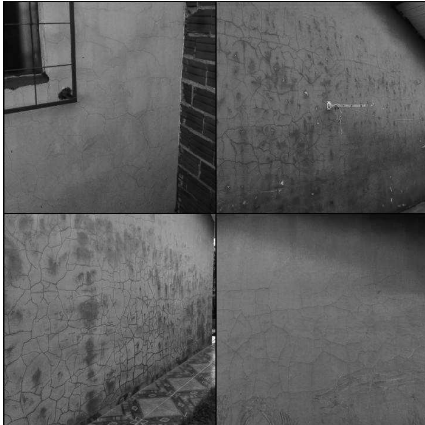
Figura 25: Fissuras mapeadas encontradas em 98% das casas visitadas
