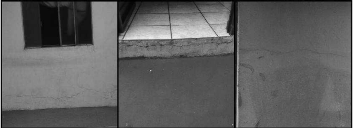
Figura 28: Trincas e fissuras horizontais
