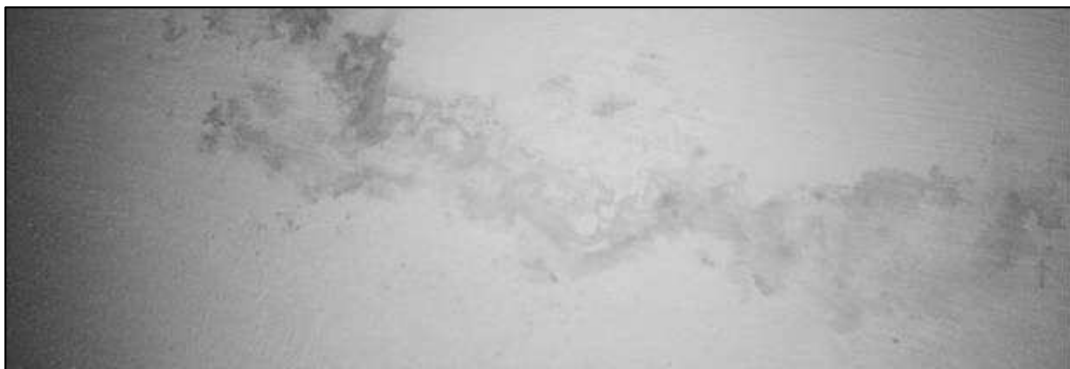
Figura 13: Mancha em pintura na parede
