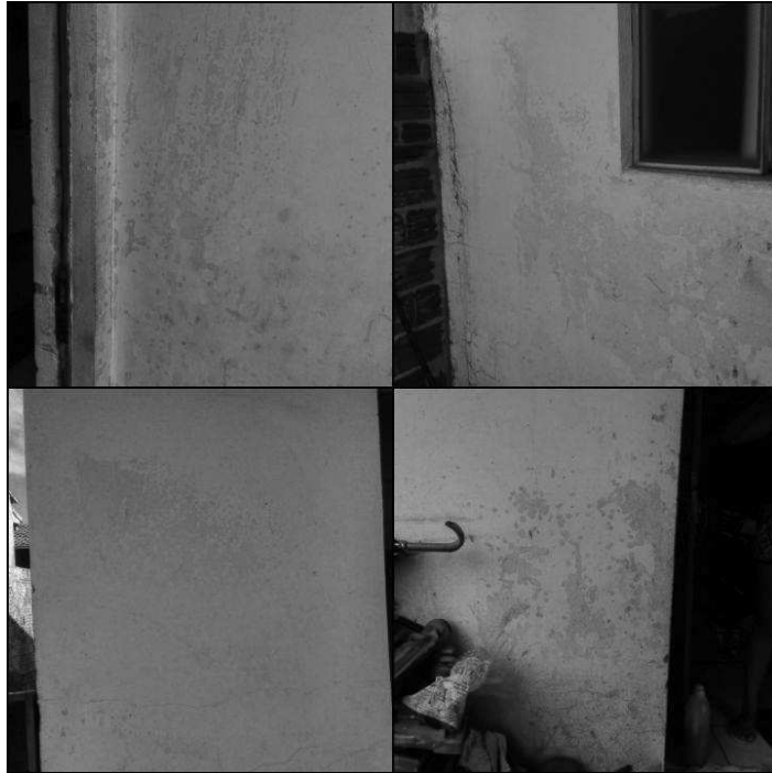
Figura 35: Aparecimento da patologia de manchas na pintura
