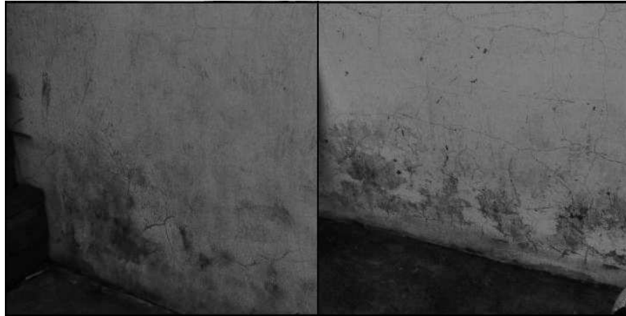
Figura 32: Patologia de bolor
