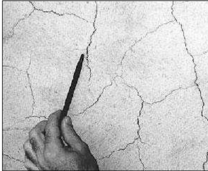
Figura 7: Trinca mapeada em parede
