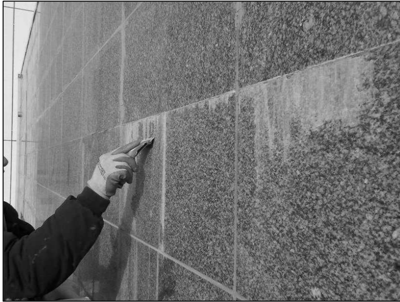
Figura 2: Eflorescência em revestimento
