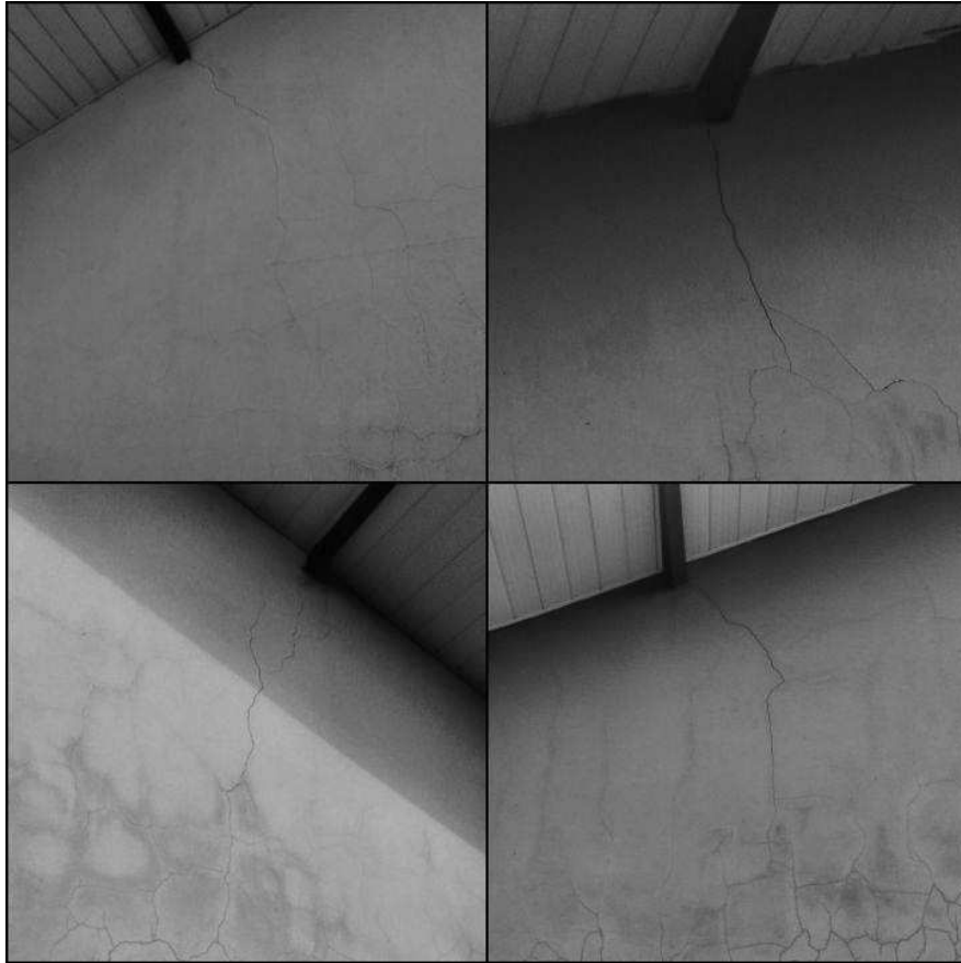
Figura 27: Trincas inclinadas em faces 4
