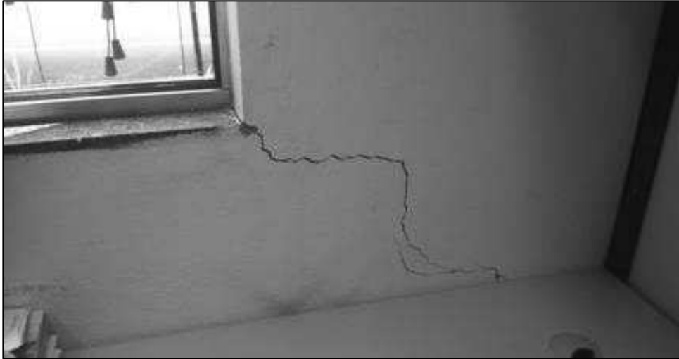
Figura 9: Trinca inclinada em alvenaria
