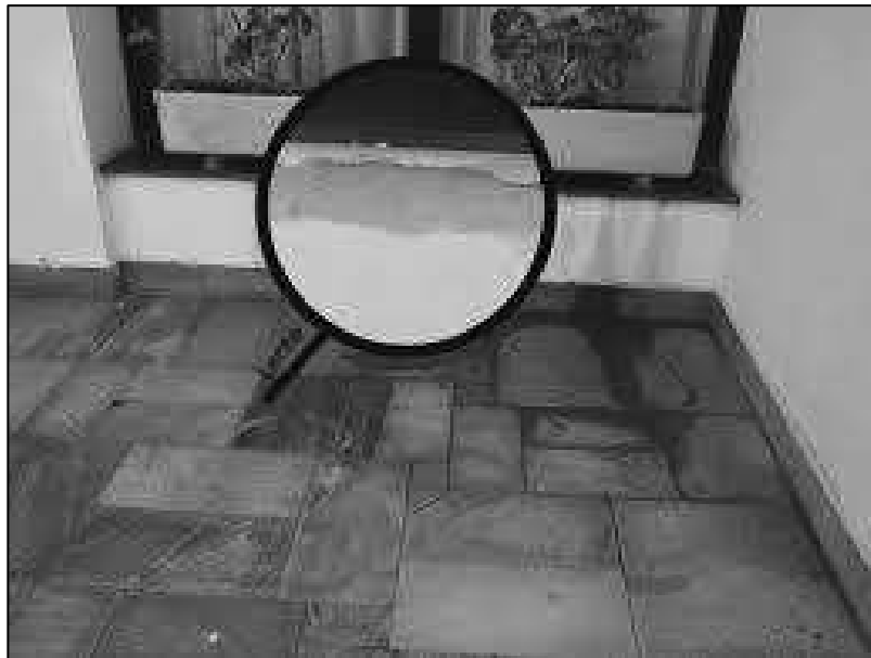
Figura 12: Incidência de descolamento com pulverulência
