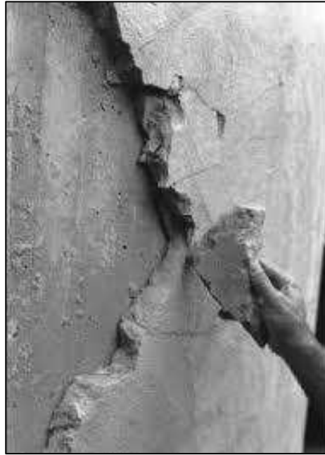
Figura 11: Descolamento em placa do revestimento
