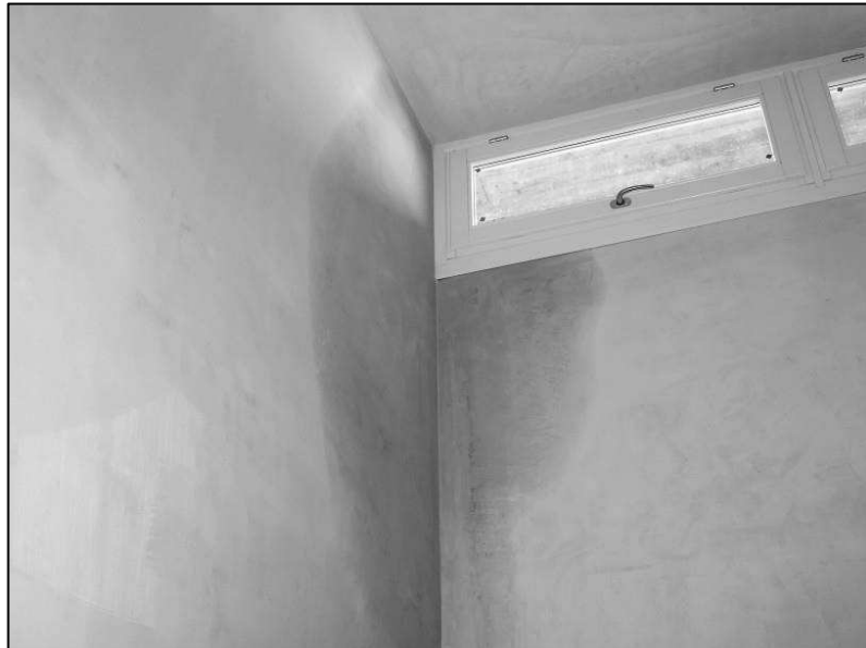
Figura 5: Mancha de umidade em parede interna
