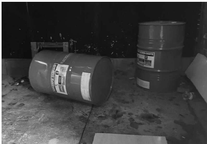
Figura 12. Toneis que continham resíduos de classe D, incorretamente dispostos na obra.
