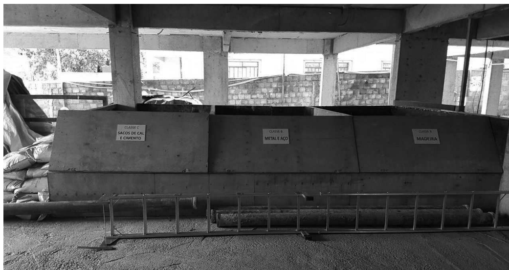
Figura 6. Baias acondicionamento de RCCs. Da esquerda para direita: resíduo classe C, sacos de cimento e cal; resíduos classe B, metal e aço; e resíduos classe B, madeira.
