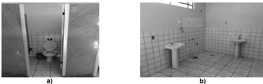
Figura 46 - a) Boxe inacessível; b) Piso, lavatórios e instalação de acessórios em desconformidade com a norma Fonte: Autoria própria (2017).
