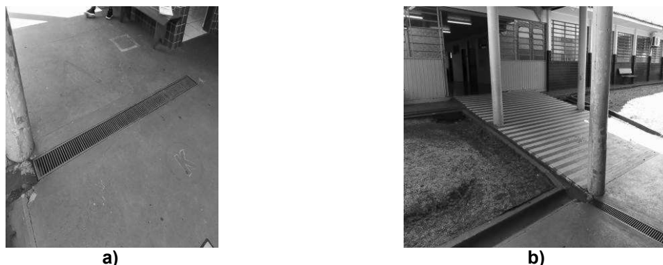
Figura 37 - a) Grelha instalada incorretamente; b) Rampa em desconformidade total com a norma Fonte: Aatoria própria (2017).
