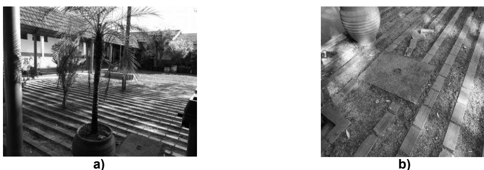
Figura 45 - a) Piso inadequado do pátio; b) Caixa de inspeção desnivelada com piso adjacente Fonte: Autoria própria (2017).
