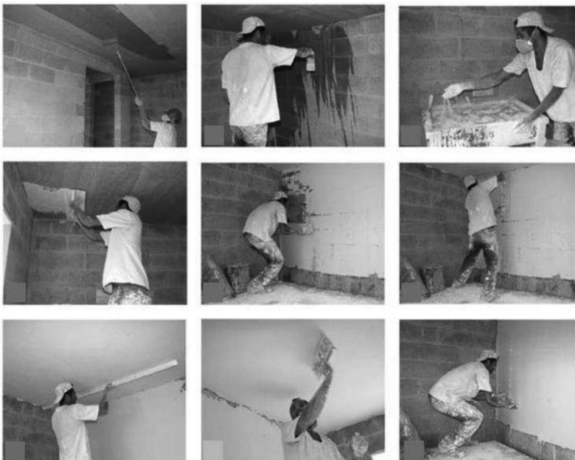
Figura 3 - Resíduos gerados pela aplicação do gesso para revestimento Fonte: Dicas da Arquiteta Mari Cecchini, 2009
