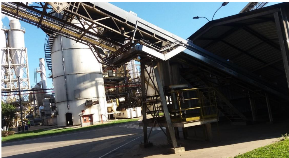
Figura 5 Esteira Transportadora de Cavacos
