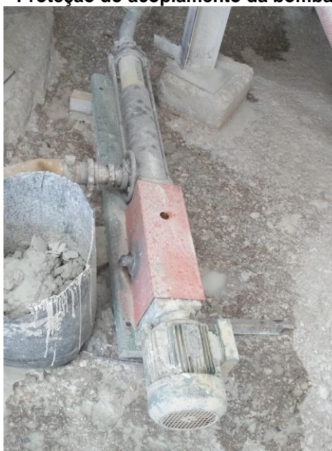
Figura 23 - Proteção do acoplamento da bomba helicoidal
