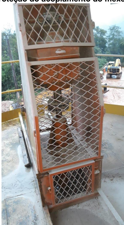
Figura 25 - Proteção do acoplamento do mexedor do silo 18
