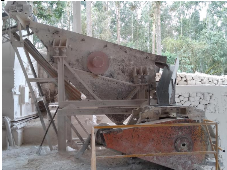
Figura 20 - Proteção da peneira vibratória e do rebitador de rolo
