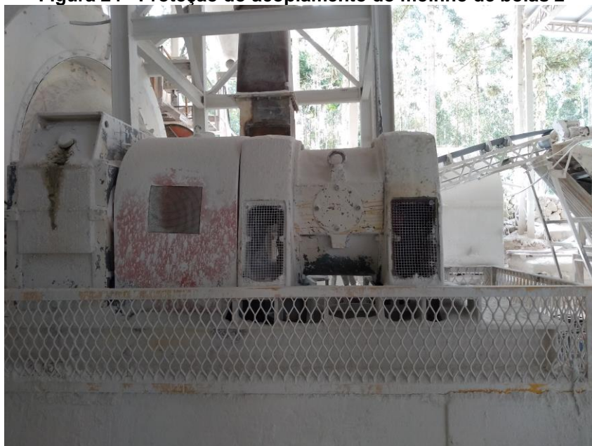
Figura 24 - Proteção do acoplamento do moinho de bolas 2
