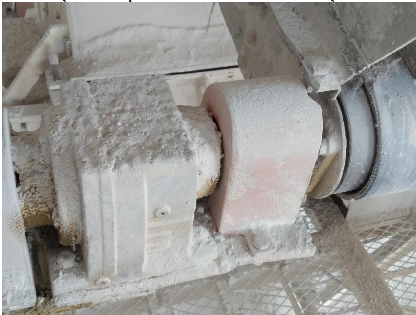
Figura 22 - Proteção do acoplamento da correia de alimentação do moinho Imetec
