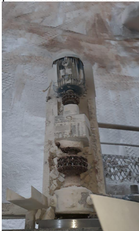
Figura 13 - Acoplamento do acionamento da correia 2 sem proteção
