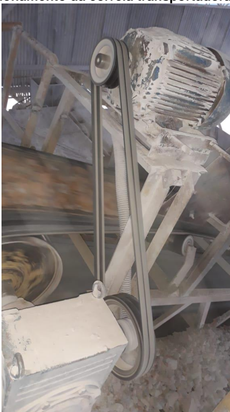
Figura 9 - Acionamento da correia transportadora 2 do calcário
