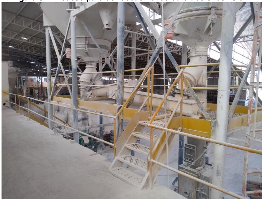
Figura 31 - Acesso para as roscas helicoidais dos silos 13 e 14
