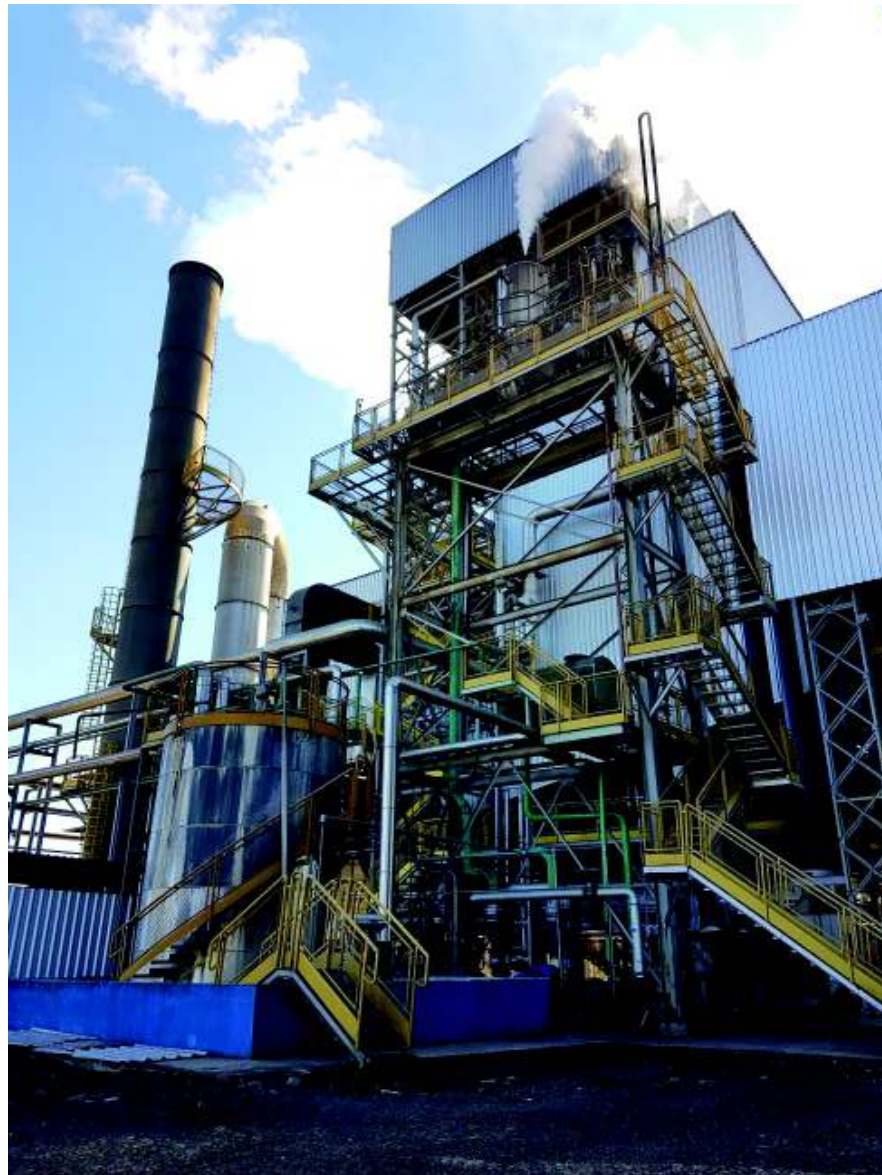
Figura 6 – Gerador de vapor ICA-05021
