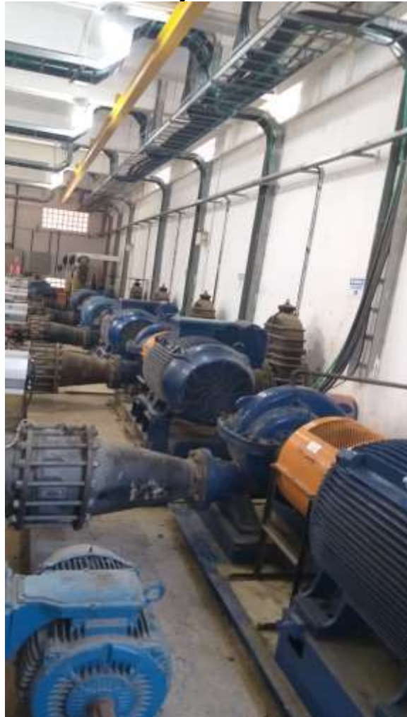
Figura 16 – Foto do arranjo das bombas no reservatório
