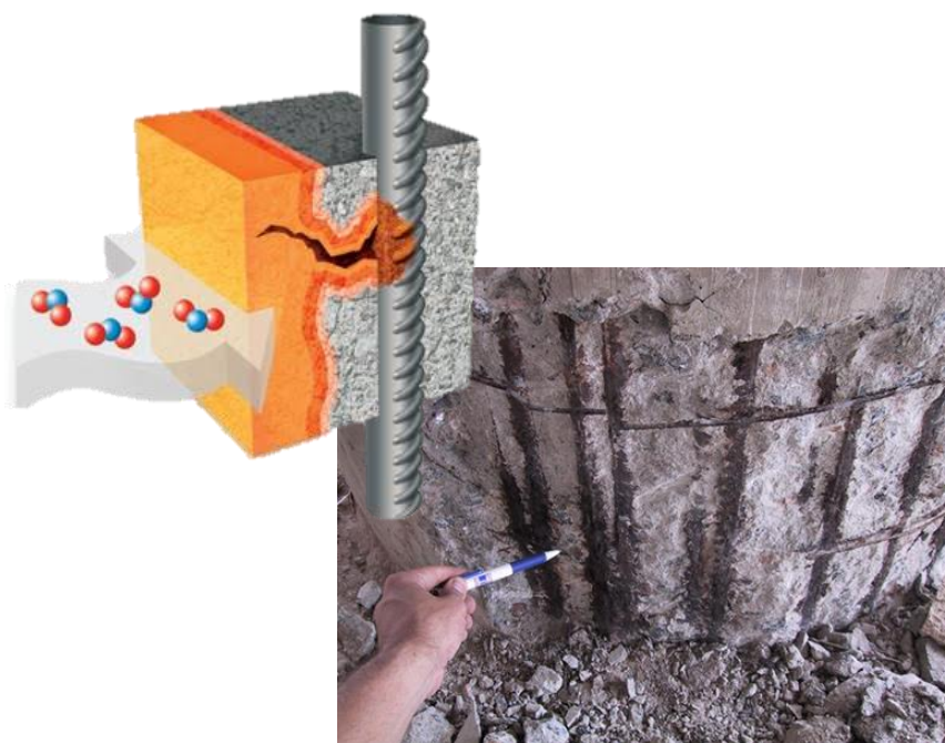
Figura 6 - Deterioração do concreto
