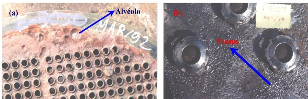
Figura 8 - Exemplos de corrosão localizada. a) corrosão localizada alveolar em espelho de trocador de calor após falha no revestimento epóxi; b) corrosão localizada puntiforme em bandeja de torre de destilação
