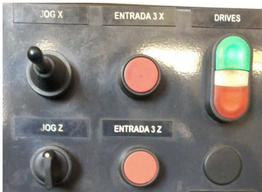
Fotografia 4 – Painel de controle Fonte: Autoria própria
