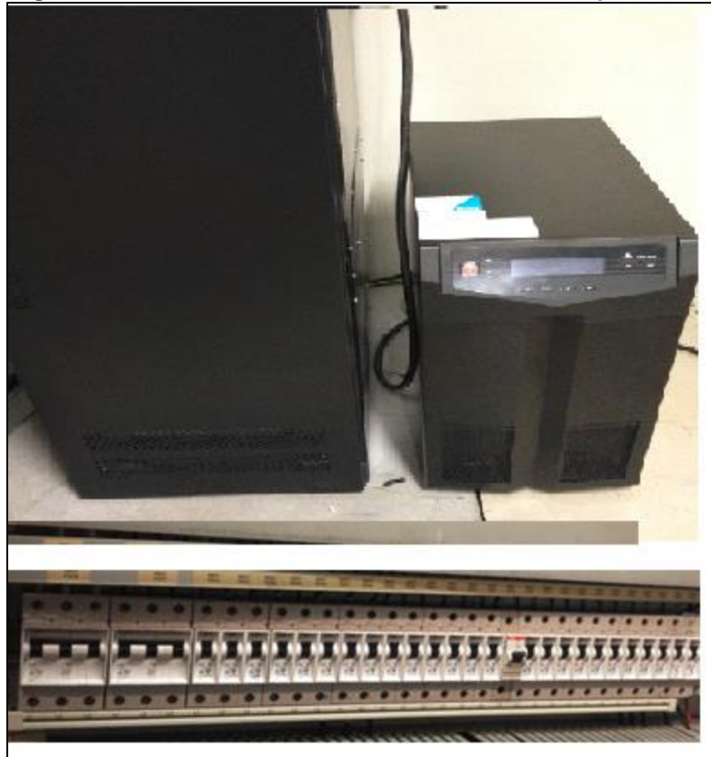
Figura 33 - No break e banco de baterias instalado proveniente da ação 63
