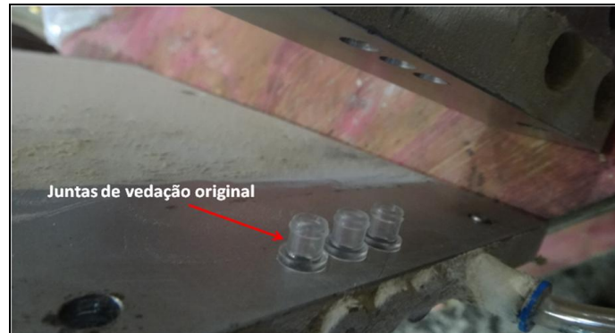
Fotografia 11 – Juntas de vedação originais do bloco de válvulas Fonte: Autoria própria
