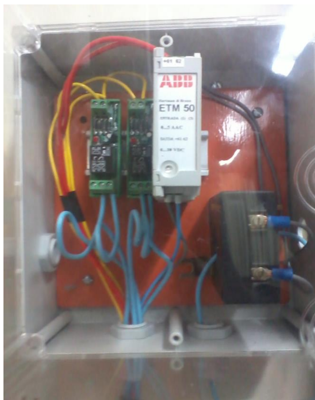
Figura 13: Caixa com sensores e acionadores Fonte: Autores (2012)
