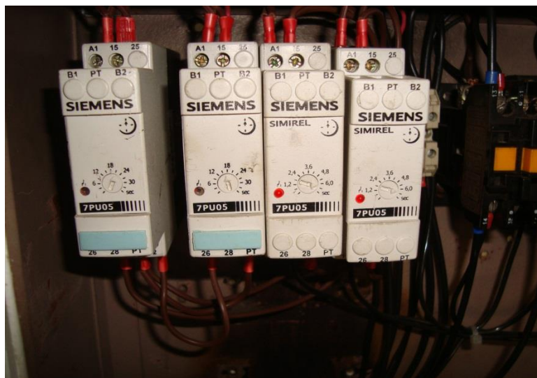
Fotografia 5: Painel com temporizadores da máquina Fonte: Autoria própria
