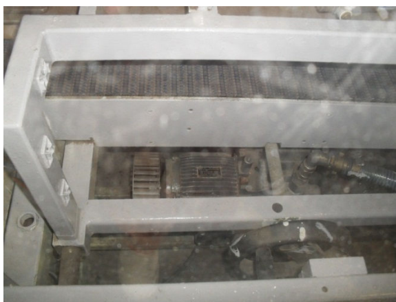
Figura 56: Foto bomba de vácuo instalada Fonte: Autoria própria
