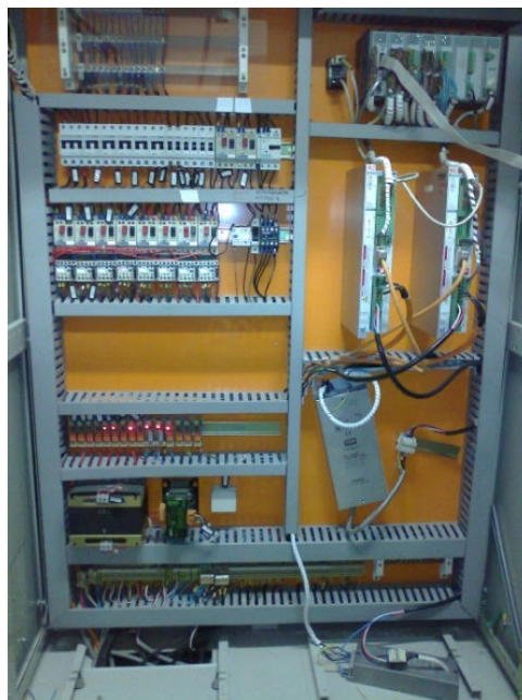
Figura 41: Foto painel de força Fonte: Autoria própria
