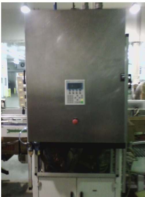
Figura 61: Foto painel com IHM fixada Fonte: Autoria própria
