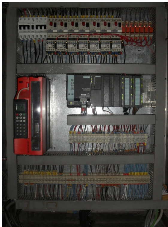
Figura 64: Foto painel elétrico montado Fonte: Autoria própria
