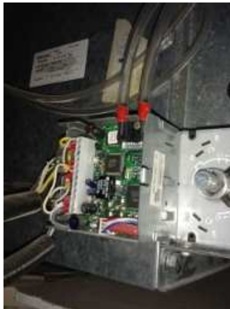
Figura 16 – Controladora da Caixa de Volume de Ar Variável Fonte: Autoria própria (2016)
