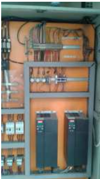
Figura 5 – Painel de Comando das bombas Secundárias Fonte: Aatoria própria (2016) (2016)
