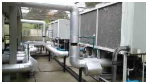
Figura 3 – Unidades resfriadoras de Água - Chiller Fonte: Autoria própria (2016) (2016)
