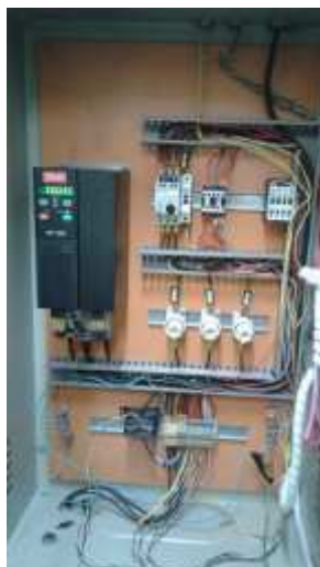
Figura 10 – Painel de Comando dos Fan Coil Fonte: Aatoria própria (2016) (2016)
