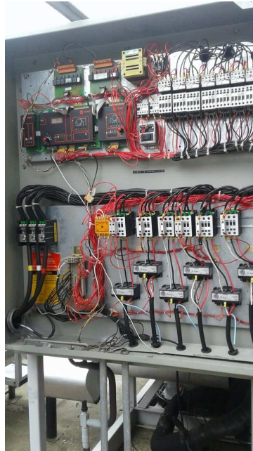
Figura 4 – Painel de Comando Elétrico do Chiller Fonte: Aatoria própria (2016) (2016)
