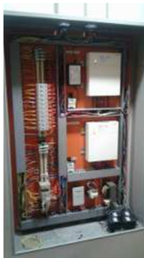
Figura 27 – Painel da Automação do Subsolo Fonte: Autoria própria (2016) (2016)
