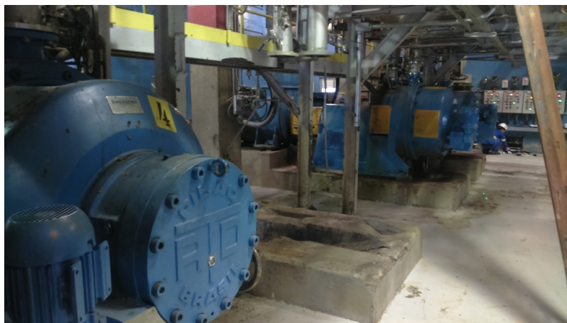
Figura 11 – Conjunto de Refinadores
