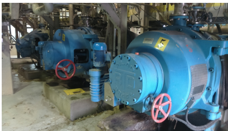
Figura 10 – Conjunto de Refinadores
