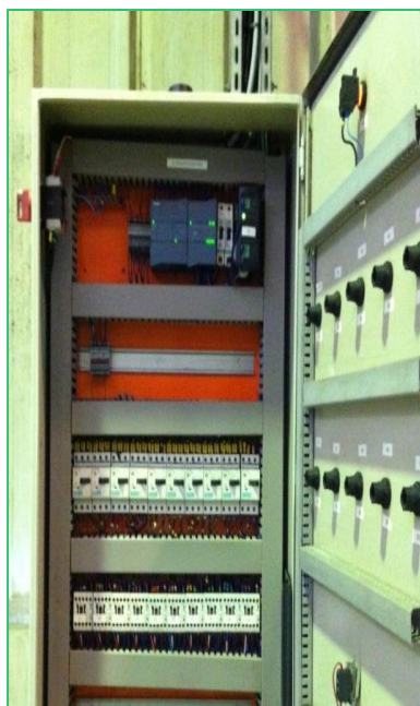
Figura 26: Painel dos CLPs do sistema de exaustão Fonte: Autoria própria.
