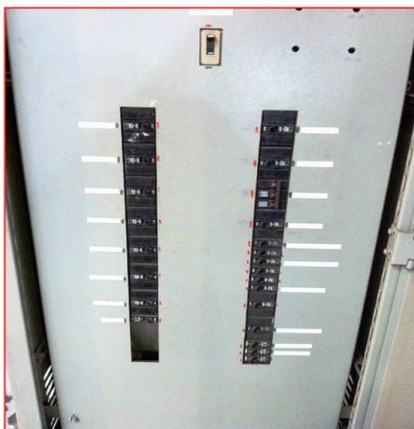
Figura 15: Antigo painel do sistema de iluminação da empresa Fonte: Autoria própria.
