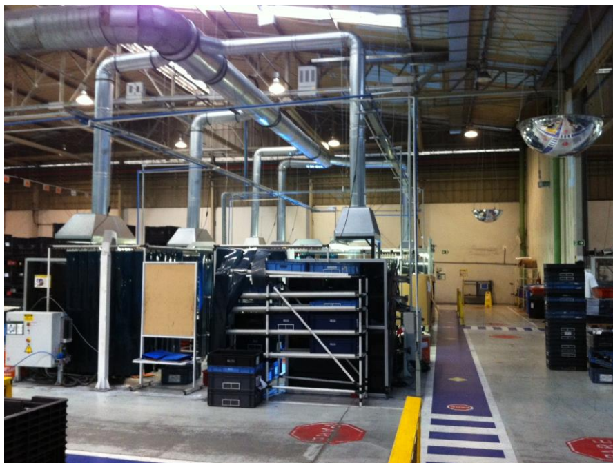
Figura 25: Foto do sistema de exaustão da empresa Fonte: Autoria própria.
