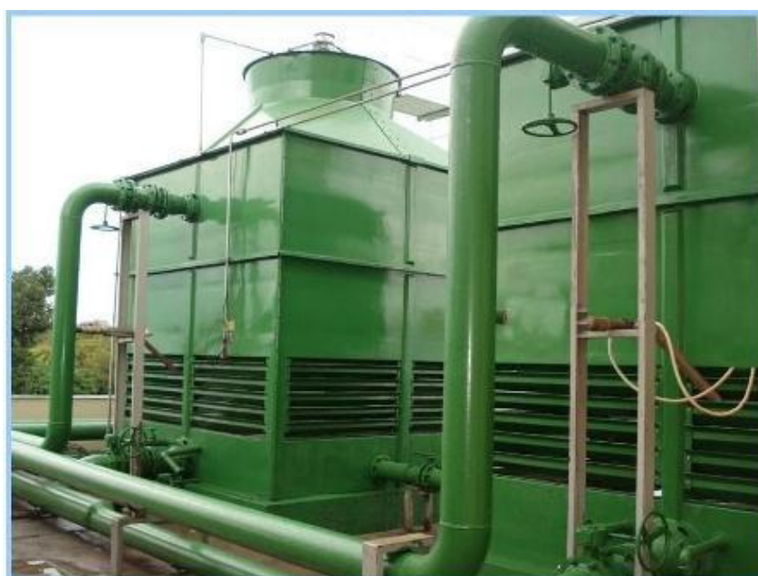
Figura 8: Torres de refrigeração Fonte: A autoria própria.
