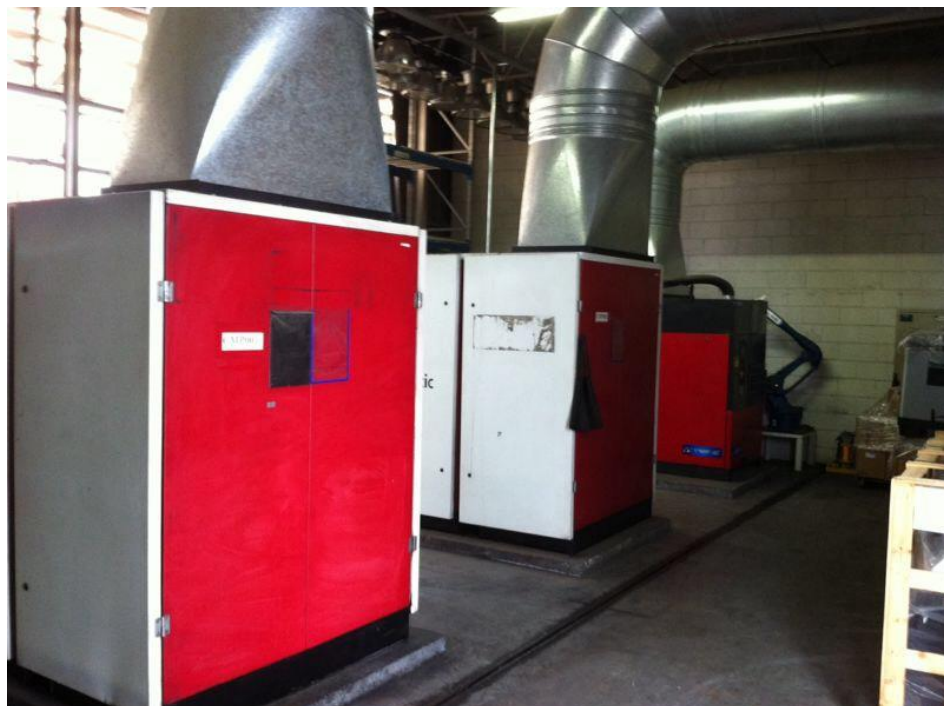
Figura 29: Compressores de ar da empresa Fonte: Autoria própria.
