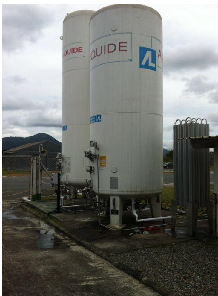
Figura 31: Tanques de armazenamento de gases de solda Fonte: Autoria própria.
