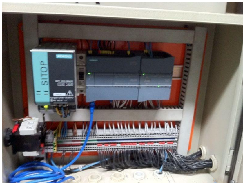
Figura 24: CLP responsável pelo controle do sistema de iluminação Fonte: Autoria própria.
