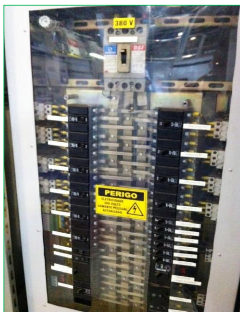
Figura 16: Painel do sistema de iluminação readaptado Fonte: Autoria própria.
