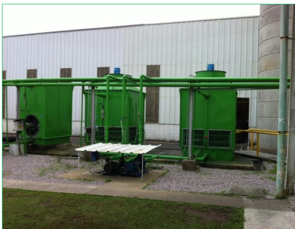
Figura 18: Torres de refrigeração da empresa Fonte: Autoria própria.
