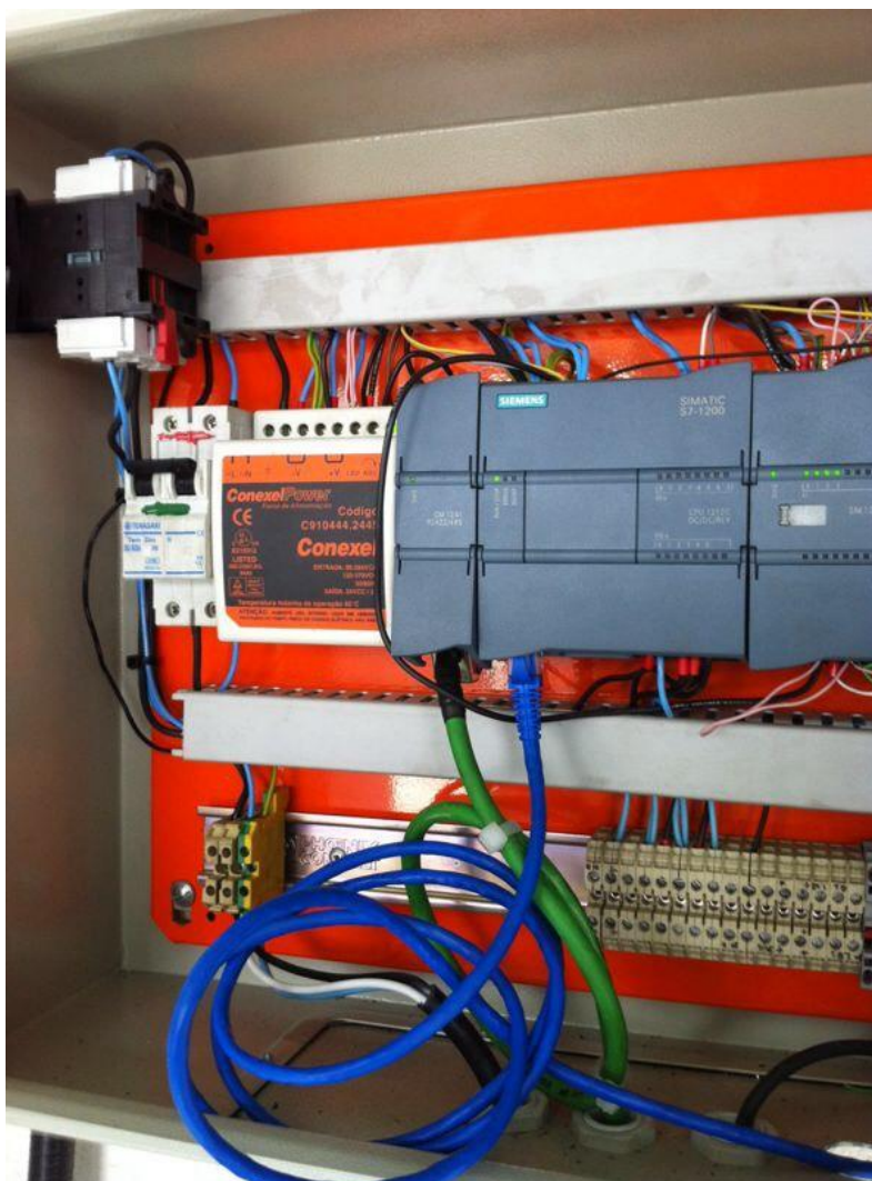
Figura 32: CLP que controla o sistema de gases de solda Fonte: Autoria própria.
