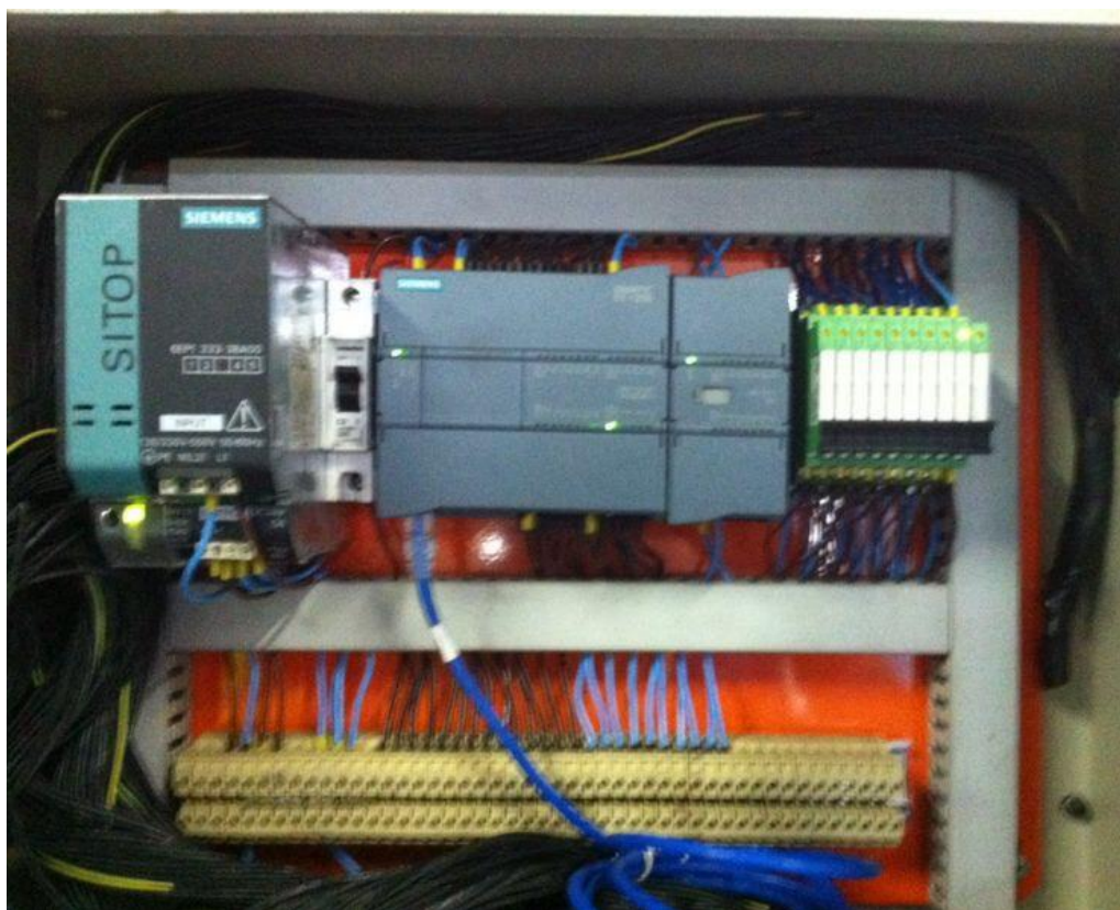
Figura 30: CLP que controla o sistema de ar comprimido Fonte: Autoria própria.
