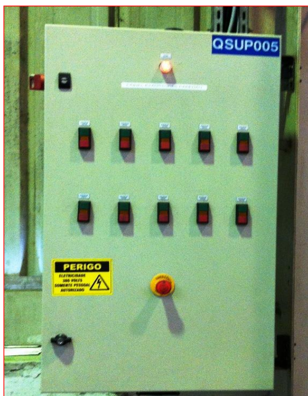
Figura 27: Como era o painel da iluminação antes da automação Fonte: Autoria própria.
