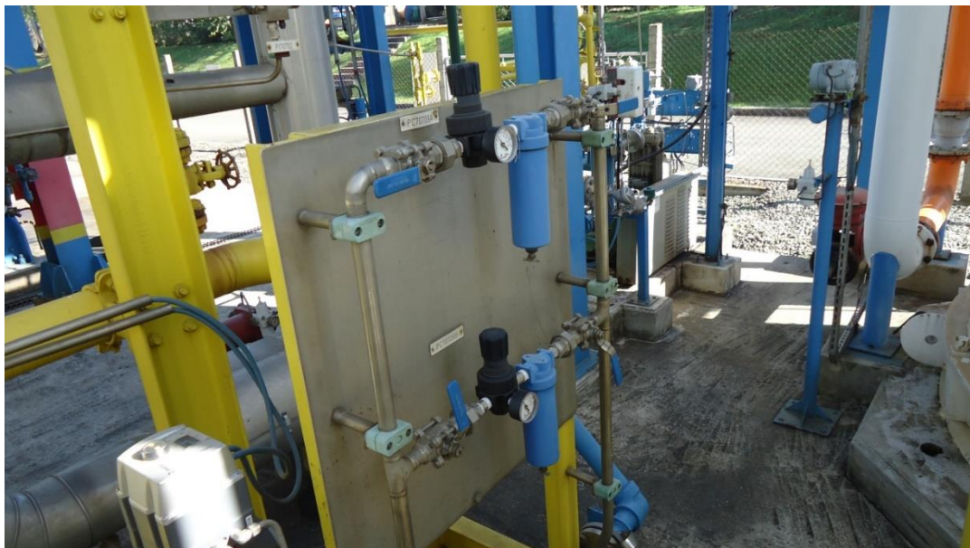
Figura 37 - Conjunto regulador e filtro. Fonte: Autoria própria.
