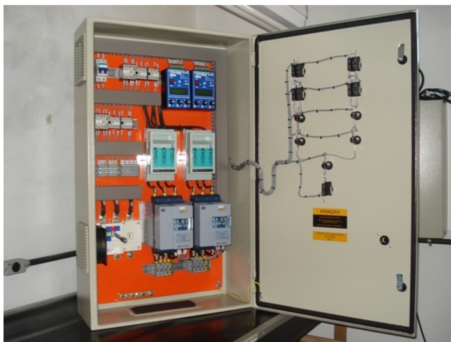
Figura 3.2 – Quadro para proteção e acionamento de duas bombas. Fonte: Autoria própria
