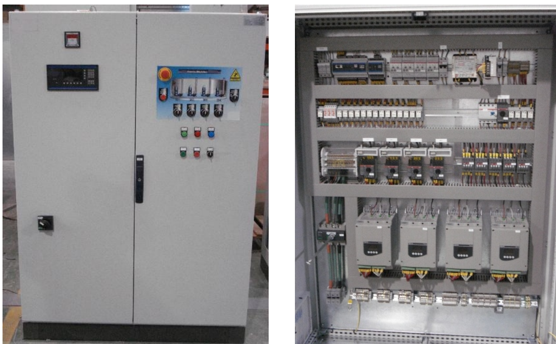
Figura 3.3 – Quadro para controle e monitoração de quatro bombas com controlador dedicado.
