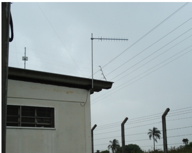
Figura 3.5 – Antena GPRS de estação elevatória. Fonte: Autoria própria
