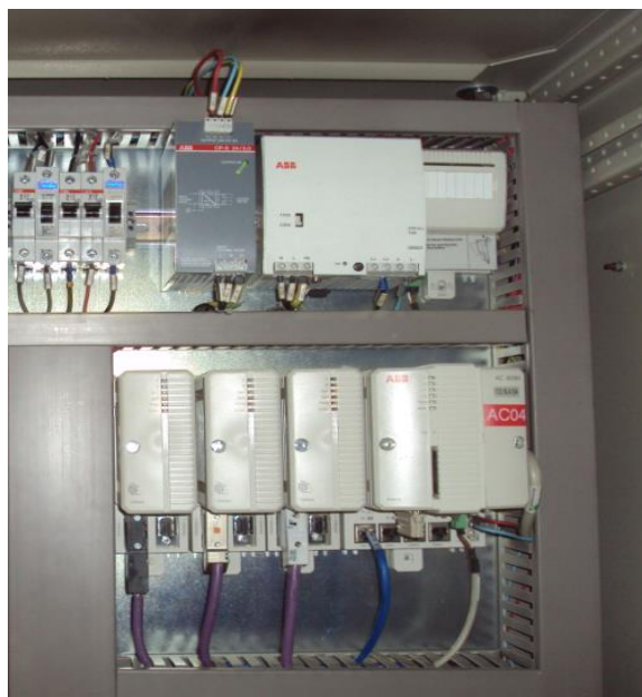
Figura 14- Painel com CLP Fonte: Autor
